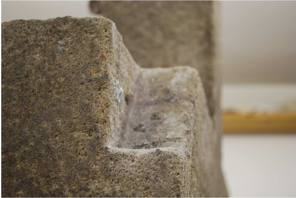
Obr. 81 Detail poškození, chybějící roh ramene kříže
