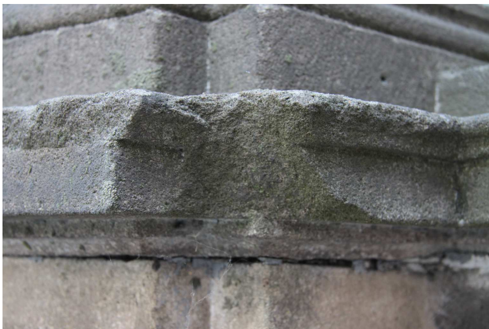
Obr. 75 Stav před restaurováním, detail poškození profilace římsy
