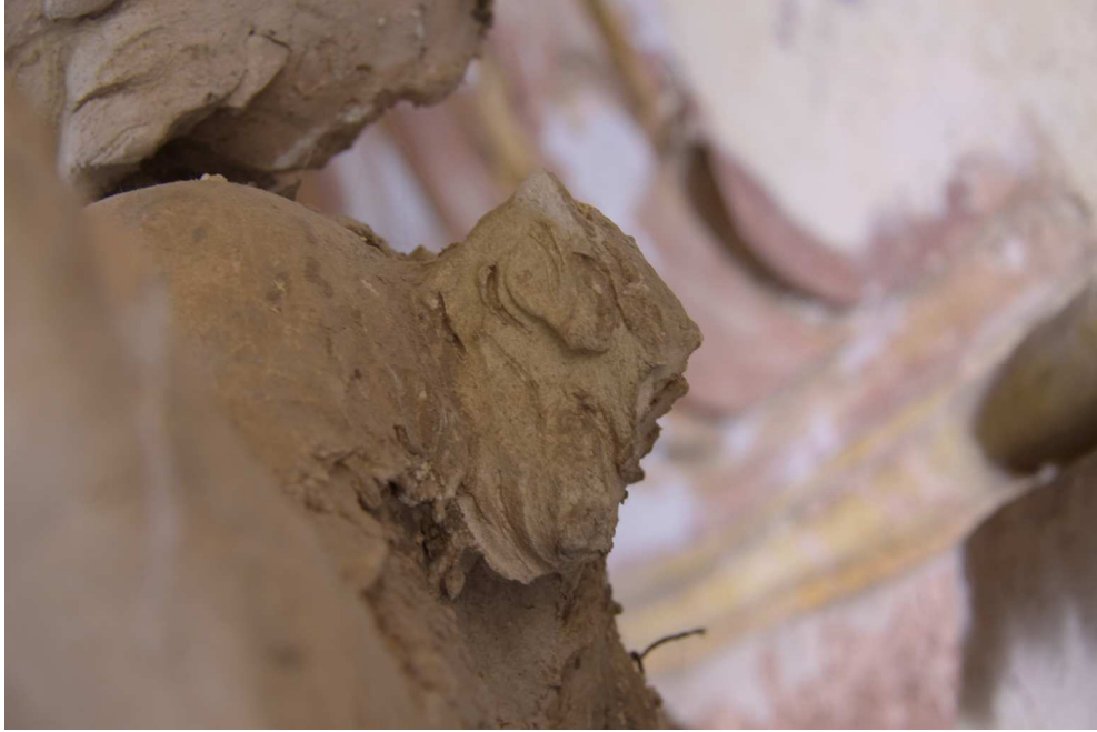
Obr. 14 Stav před restaurováním, detail levého křídla
