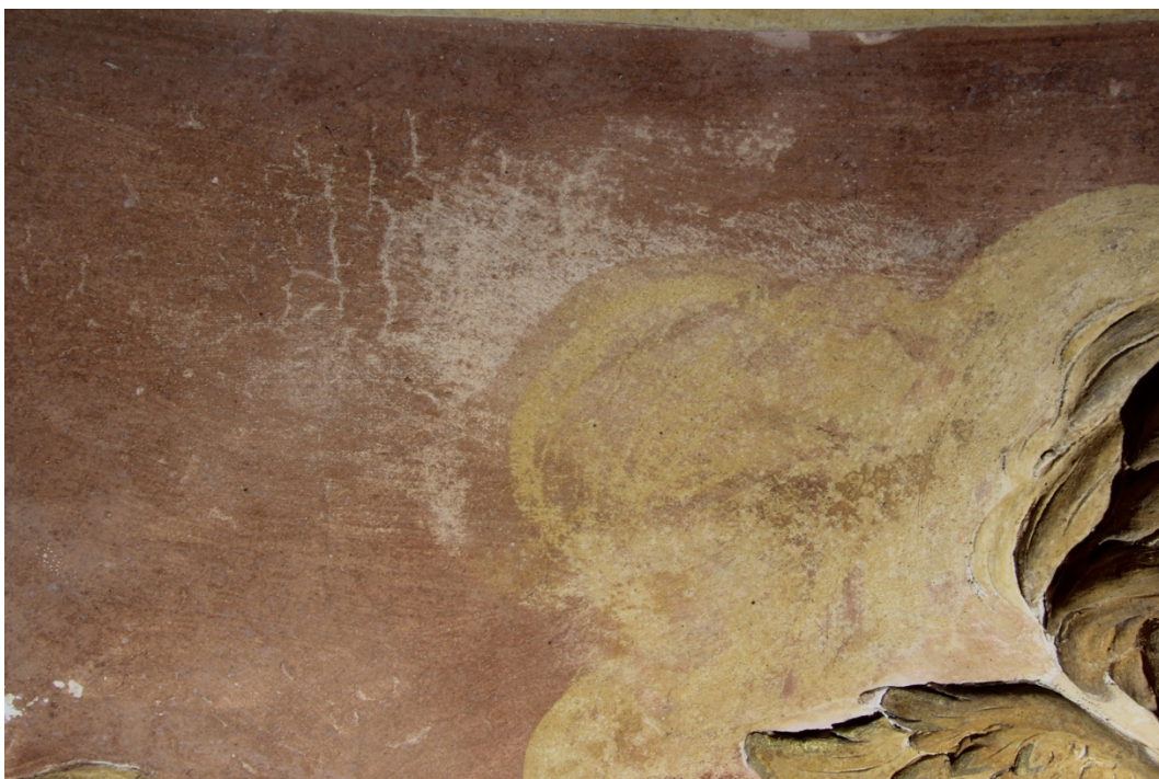
Obrázek 46 – dokumentace stavu poškození, růžové pozadí hladké omítky. Na této fotografii je patrný další příklad degradace barevných vrstev. Zde se nalézá oblast, kde došlo k výraznému narušení koheze barevných vrstev, která se projevuje jejím zpráškovatěním.
