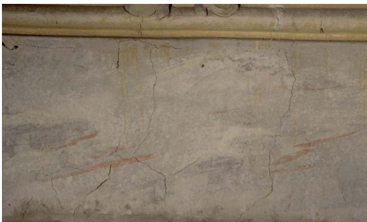
Obrázek 81 - dokumentace postupu prací. Středová část pásu s iluzivní povrchovou úpravou. Stav před restaurováním.
