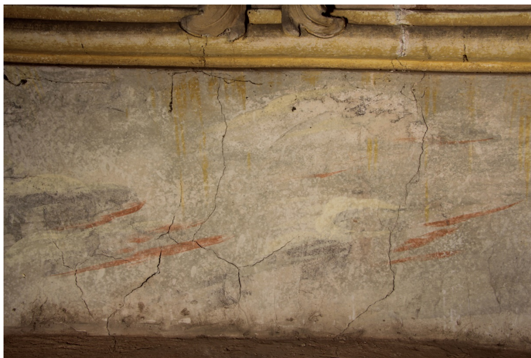
Obrázek 51 – dokumentace poškození, pás s mraky. Po celé ploše zobrazované části se nachází síť širokých prasklin. U horního okraje pásu jsou patrné stěkance okrového nátěru štukové římsy. Barevná vrstva je na mnoha místech oslabena, nebo dokonce chybí.
