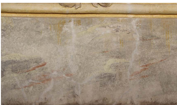
Obrázek 82 - dokumentace postupu prací. Středová část pásu s iluzivní povrchovou úpravou. Stav po vyčištění, vyplnění hloubkových dutin a vytmelení.
