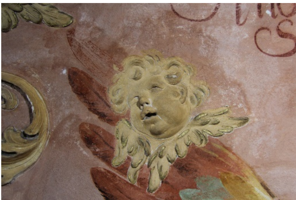
Obrázek 77 – dokumentace průběhu prací, andělská hlava s křídly a její okolí, stav po očištění, konsolidaci a vytmelení defektů.
