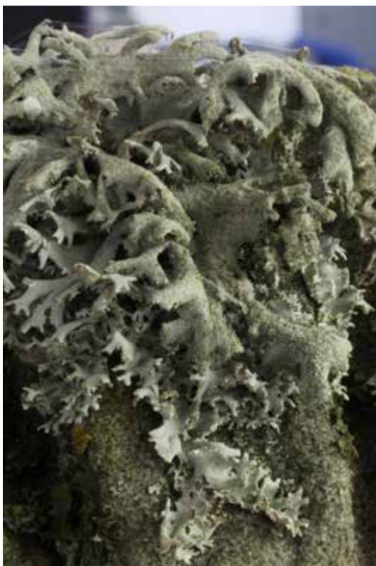
Obrázek 62 - Detail biologického napadení objektu
