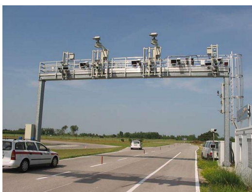
Obr. 8 – Plně osazená mýtná brána
