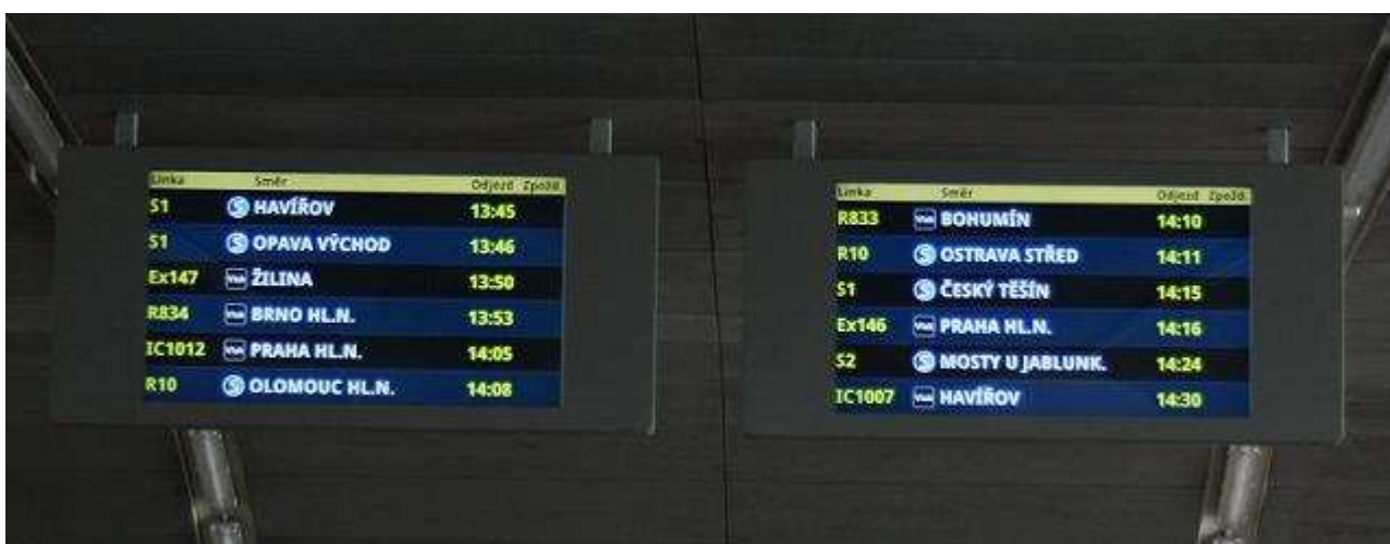
Obr. 17 Elektronické informační tabule umístěné v přestupním uzlu Svinov, mosty; Ostrava
