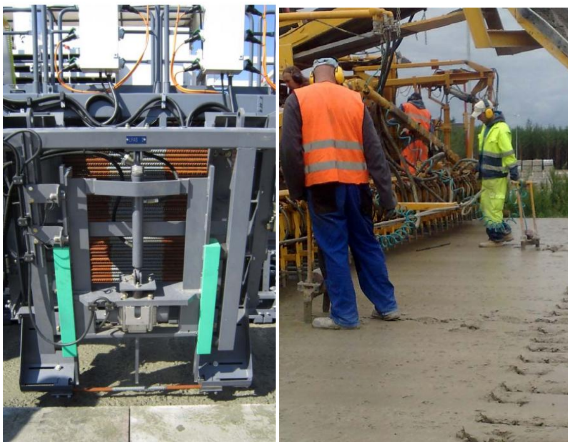
Obr. 18 Zatlačecí zařízení kotev na finišeru Wirtgen SP 1500 (vlevo) a ruční zatlačení kotev při pokládce CB krytu pomocí finišeru Hailit+Woerner (vpravo)
