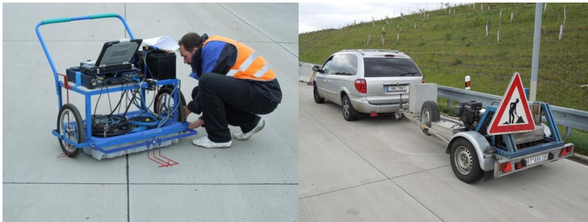
Obr. 88 Nasazení nedestruktivních metod při hodnocení polohy kluzných trnů a kotev na pokusných úsecích
