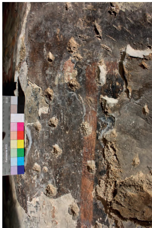
Východní stěna. Na snímku jsou patrné solné mapy vzniklé v důsledku zvýšeného obsahu vodorozpustných solí ve zdivu.
