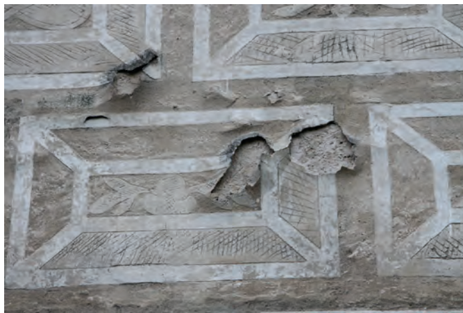
Poškození sgrafitové výzdoby. Destrukce a oddělování povrchové vrstvy omítky.
