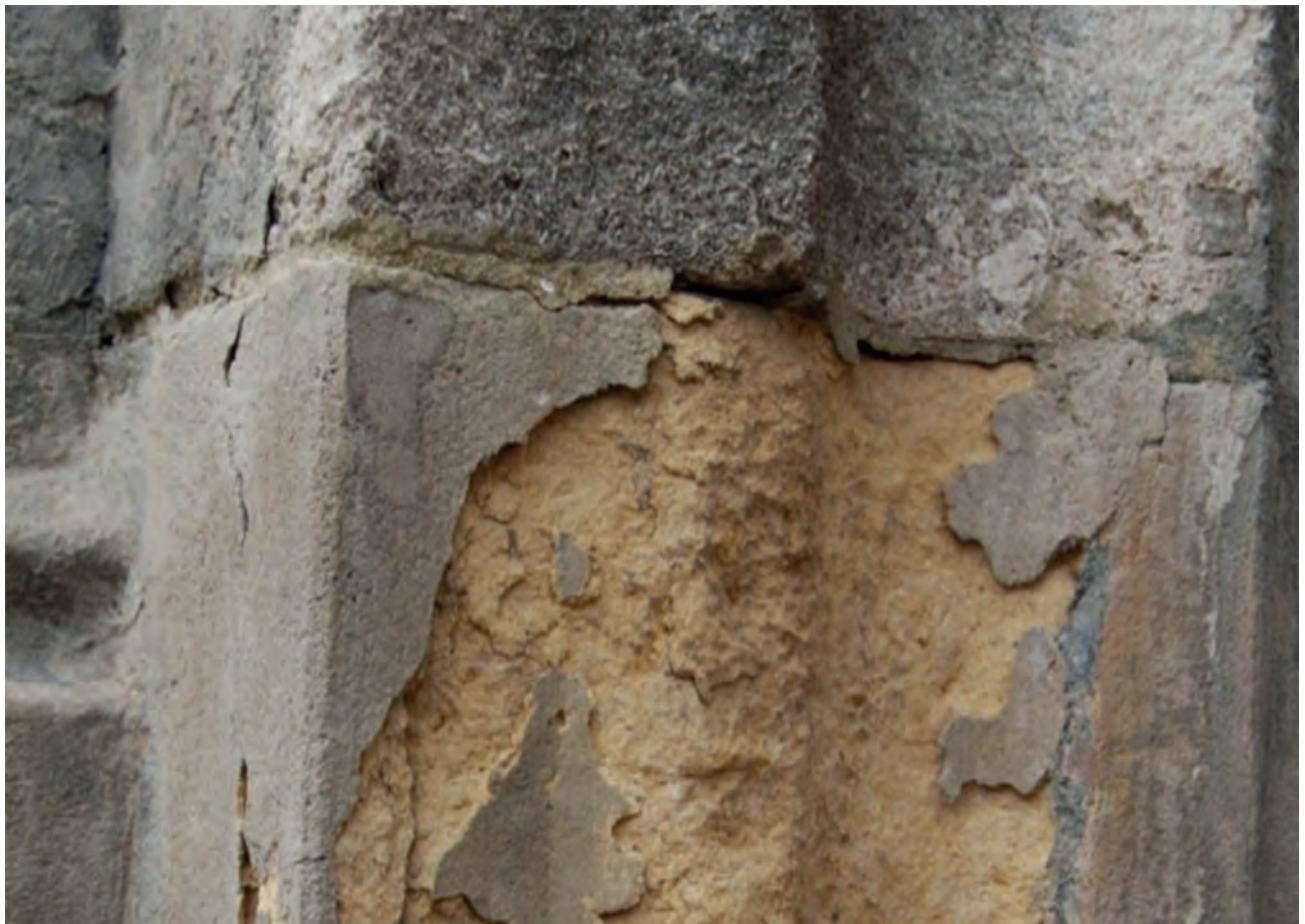
Narušení pískovce pod cementovým přetěrem, styk vápence a pískovce.
