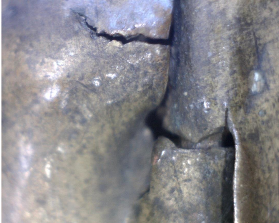
Obr. č. 33 Pohled na mikropraskliny v kovovém pokryvu z USB mikroskopu
