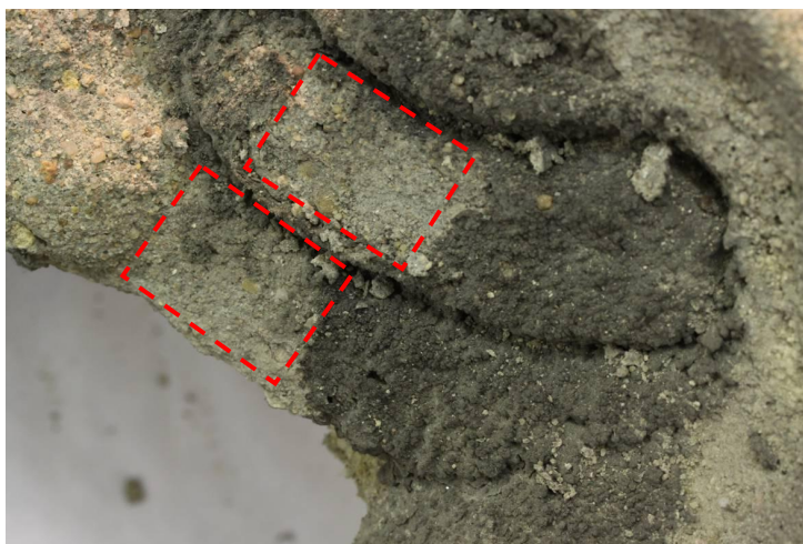
Obrázek č. XXIII, Zkoušky čištění mikroabrazí na tmelu.
