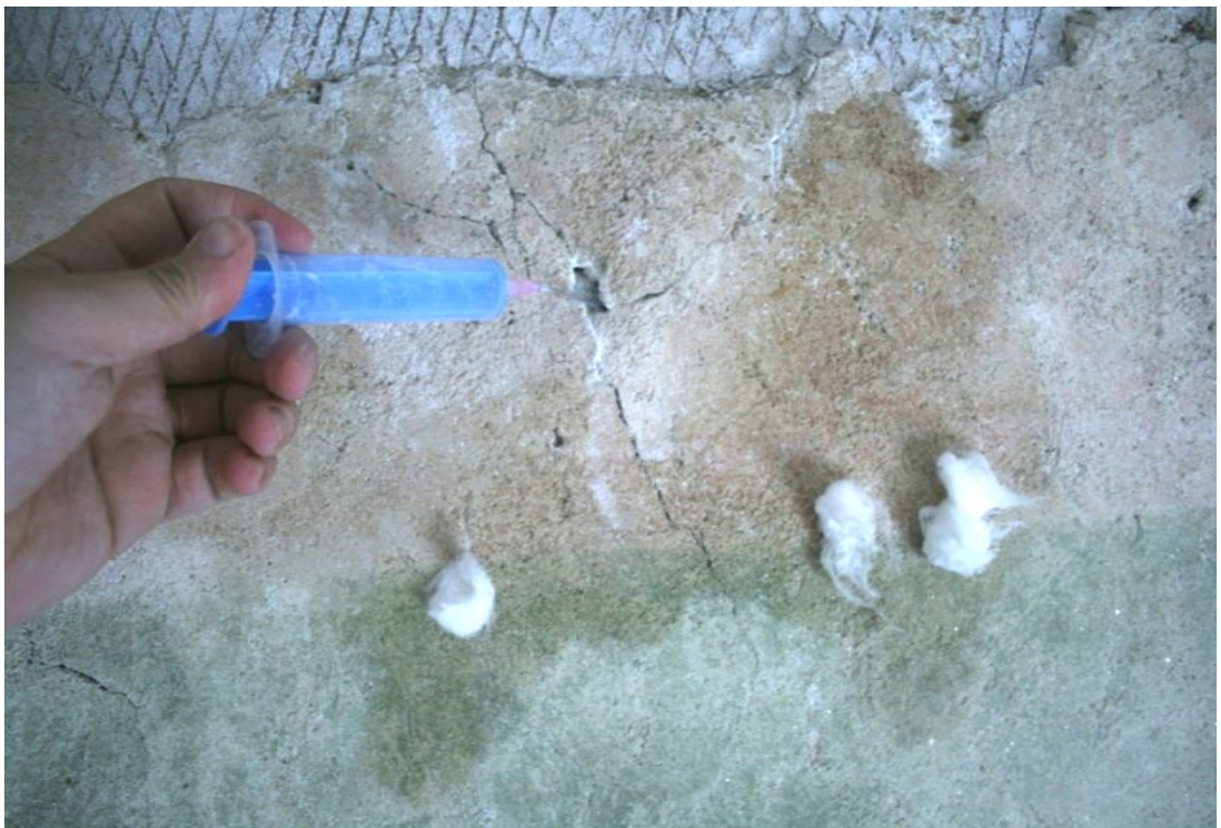
obr. 14, Loukov, kostel sv. Markéty, vítězný oblouk, Boj sv. Jiří s drakem , hloubková injektáž trhlín Ledanem D2
