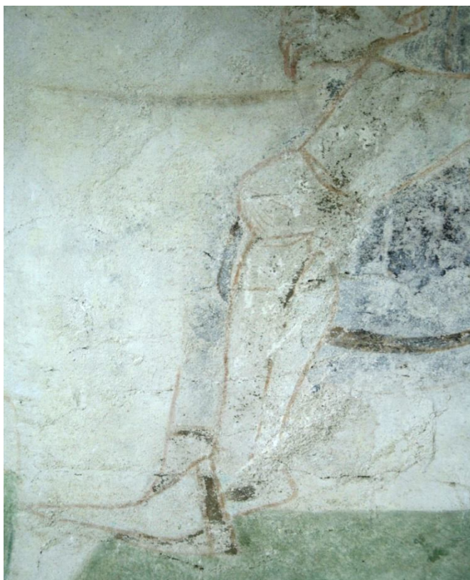
obr. 14, Loukov, kostel sv. Markéty, východní stěna lodi, Boj sv. Jiří s drakem , stav dochování barevné vrstvy (degradace secco malby – podkladová kresba)
