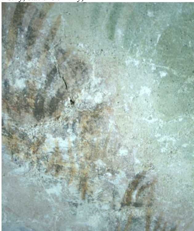
obr. 13, Loukov, kostel sv. Markéty, Boj sv. Jiří s drakem , stav dochování barevné vrstvy (prachový depozit, druhotné retuše, nedočistěné zbytky nátěrů, šupinkovatění barevné vrstvy, statické trhliny)
