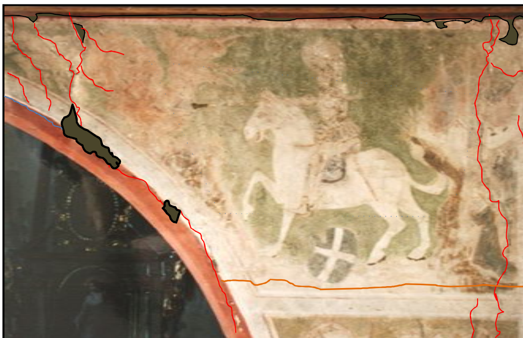
obr. 3, Poškození nástěnné malby:
