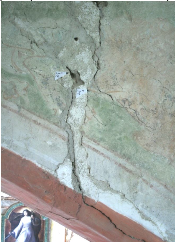
obr. 11, Loukov, kostel sv. Markéty, východní stěna lodi, Boj sv. Jiří s drakem , statická trhлина s druhotnou vysprávkou, odběr vzorků (LsvM/4.,6.)
