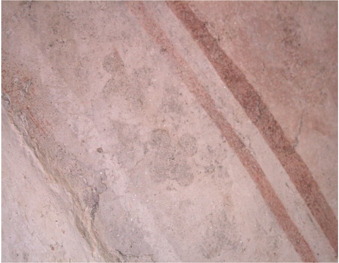
obr. 36, Loukov, kostel sv. Markéty, vítězný oblouk, Boj sv. Jiří s drakem , stav po závěrečné retuši (detail rozetového ornamentu)
