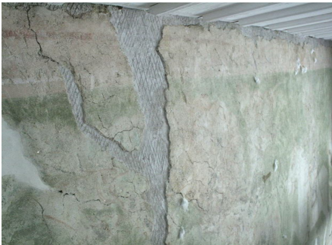
obr. 18, Loukov, kostel sv. Markéty, vítězný oblouk, Boj sv. Jiří s drakem , stav po vytmelení hloubkovým tmelem
