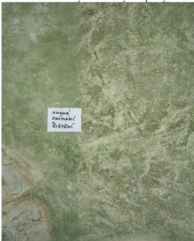
obr. 26, Loukov, kostel sv. Markéty, vítězný oblouk, Boj sv. Jiří s drakem , zkouška povrchového čištění pryží a čistícím těstem
