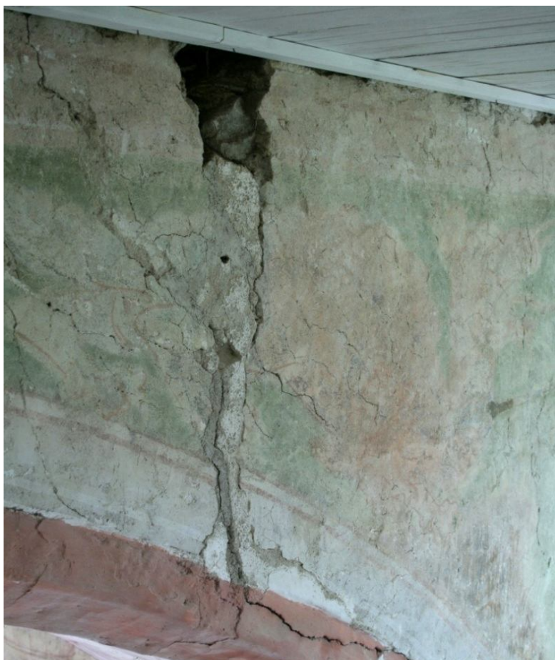
obr. 16, Loukov, kostel sv. Markéty, vítězný oblouk, Boj sv. Jiří s drakem , stav dochování, hluboké statické trhliny ve středu vítězného oblouku
