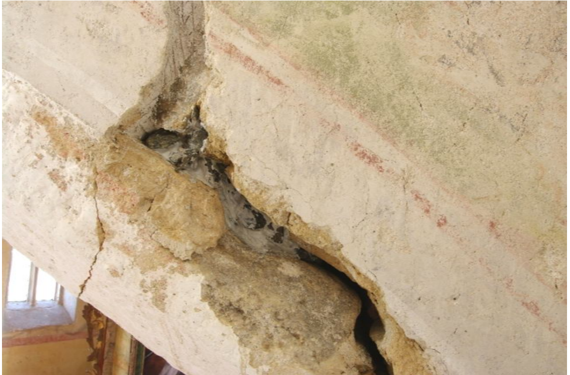
obr. 15, Loukov, kostel sv. Markéty, vítězný oblouk, Boj sv. Jiří s drakem , spojovacími můstky provedené z epoxidové pryskyřice Akepox 2040 k fixaci utržené části podhledu vítězného oblouku
