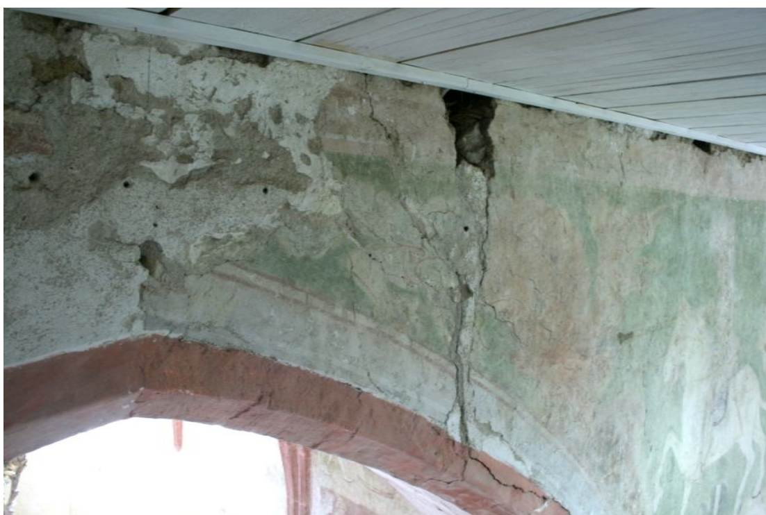
obr. 15, Loukov, kostel sv. Markéty, vítězný oblouk, Boj sv. Jiří s drakem , stav dochování, hluboké statické trhliny ve středu vítězného oblouku, ztráty barevné vrstvy malby
