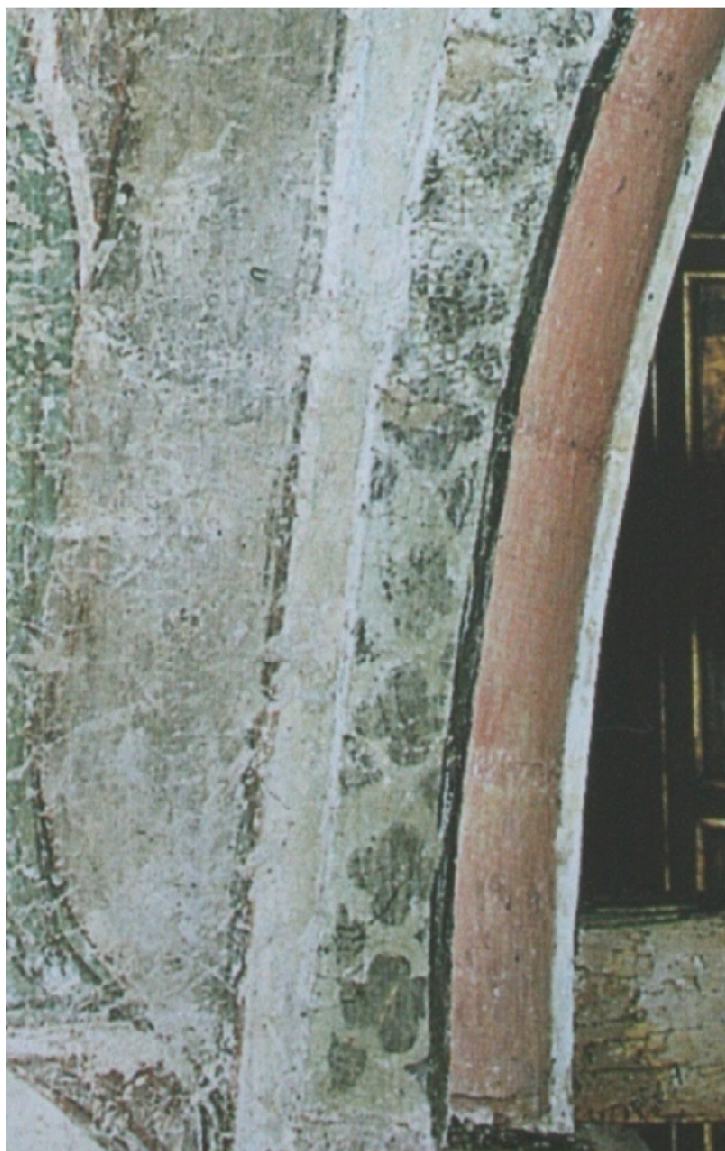
obr. 10, Libiř, kostel sv. Jakuba, kolem 1390, nstnn malby v severn části vchodn stny lodi, dekor šablonovch rozet
