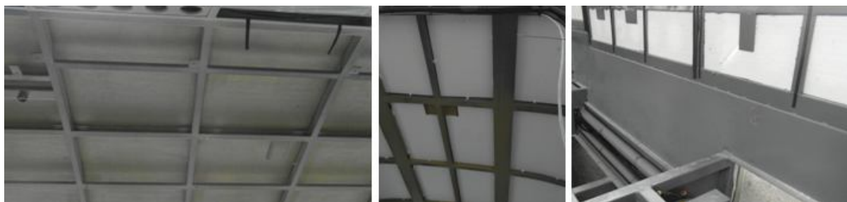
Obrázek 7 Vnitřní strana střechy bez izolace a s izolací, vnitřní strana bočnice s izolací
