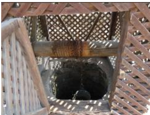
Obrázek 5-6 Zdroj pitné vody – studna Osečina - Belotić
