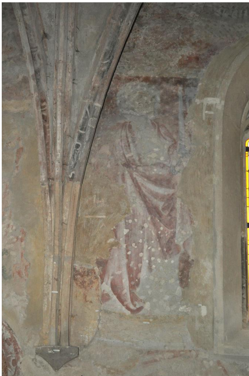
Obrázek 24 – Celkový pohled na referenční plochu, stav po částečném vyretušování tmelů
