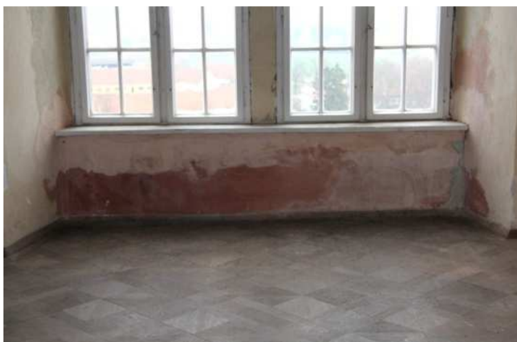
Obr. 6 Degradace materiálu způsobená zatékáním vody přes netěsnící okno.
