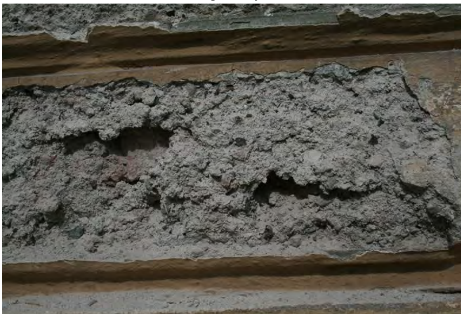
Obr. 45 Degradovaná jádrová omítka v místě defektu štukové vlnovky v dolní části fasády
