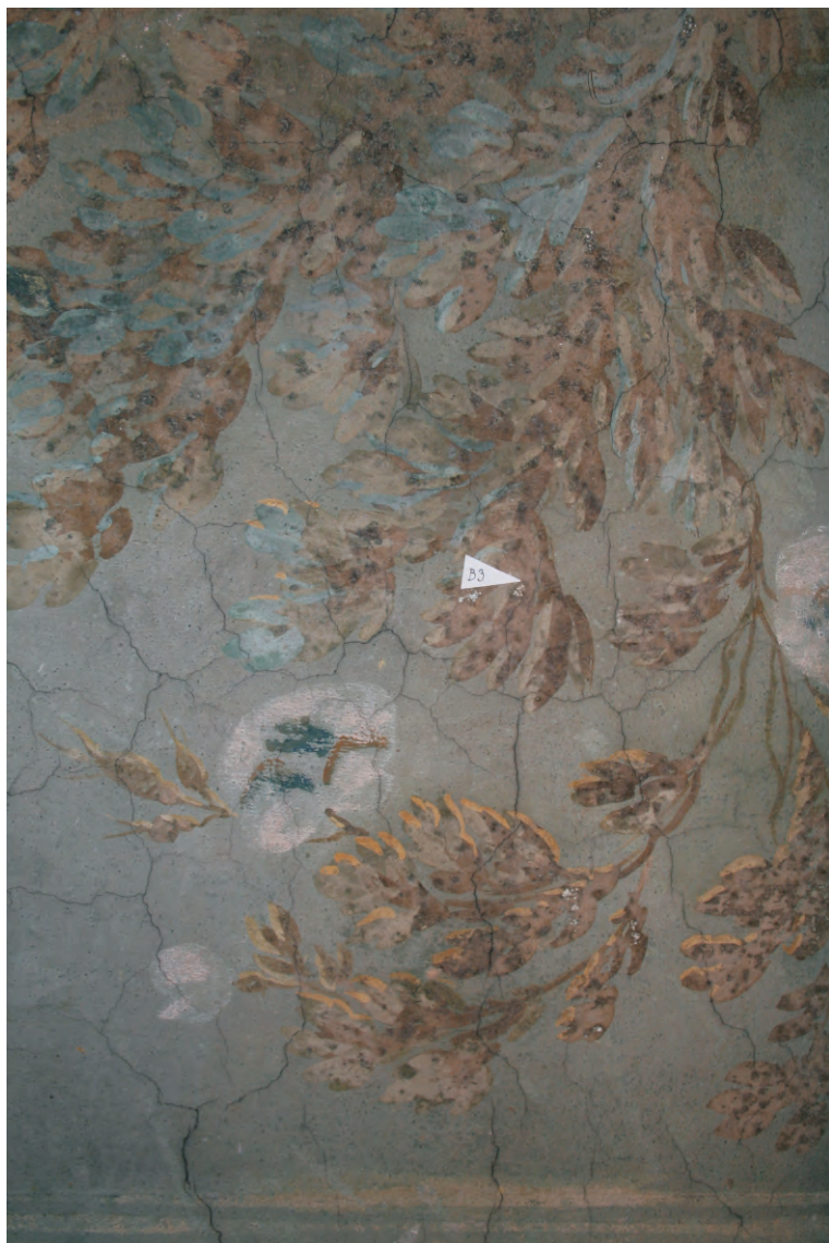
Obr. 40 Biologické napadení v oblasti keře v pravé části obrazu s místem odběru vzorku k mikrobiologickým zkouškám.
