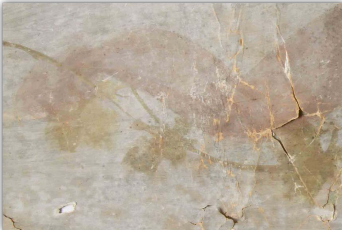
20. Obrázek: stav před restaurováním; detail poškození vlhkostí; snímáno v denním rozptýleném světle
