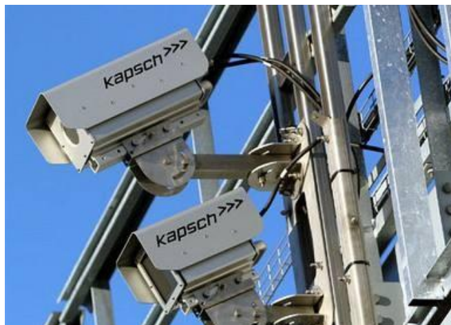
Obrázek č. 16 - Technické vybavení mýtných bran
