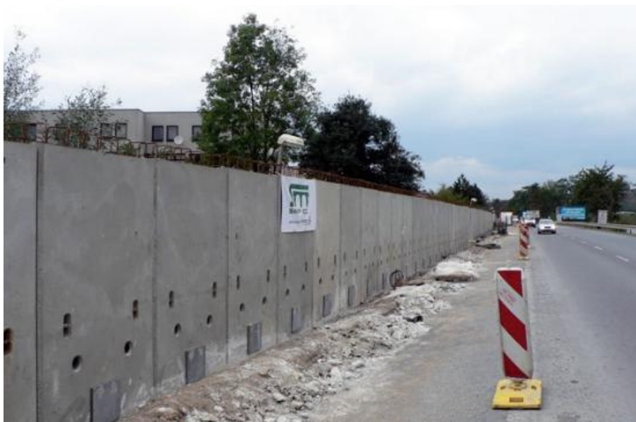
Obrázek 23: Protipovodňová ochrana Zbraslavi
