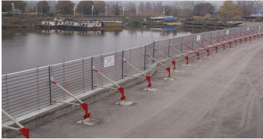
Obrázek 21: betonová zeď s mobilním hrazením na ochranu Holešovic a Stromovky
