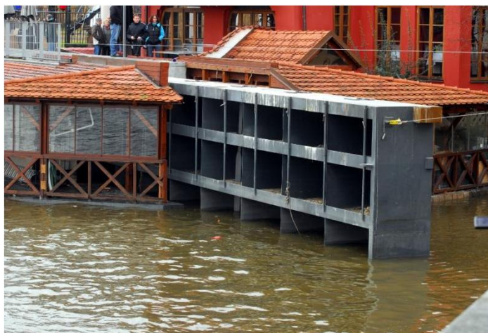
Obrázek 14: ocelová posuvná stěna pro ochranu Čertovky
