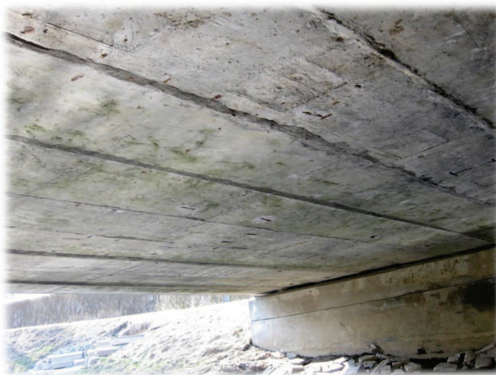
Obrázek 16 – Patrné prokreslení korodující výztuže nosníků
