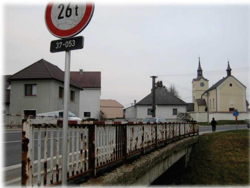
Obrázek 3 – Celkový pohled na most z výtokové strany, neodpovídající SDZ mostní evidenci BMS
