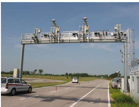
Obrázek č. 1 – Plně osazená mýtná brána
