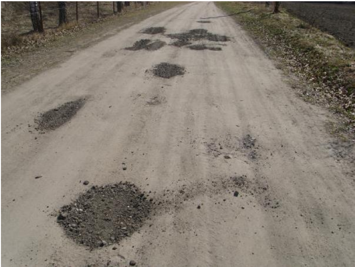
Obrázek 9: Pohled na nebezpečný povrch
