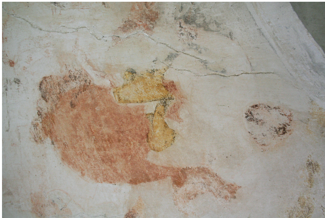
obr.17 - Lov na medvěda drobné prasklinky statického původu
