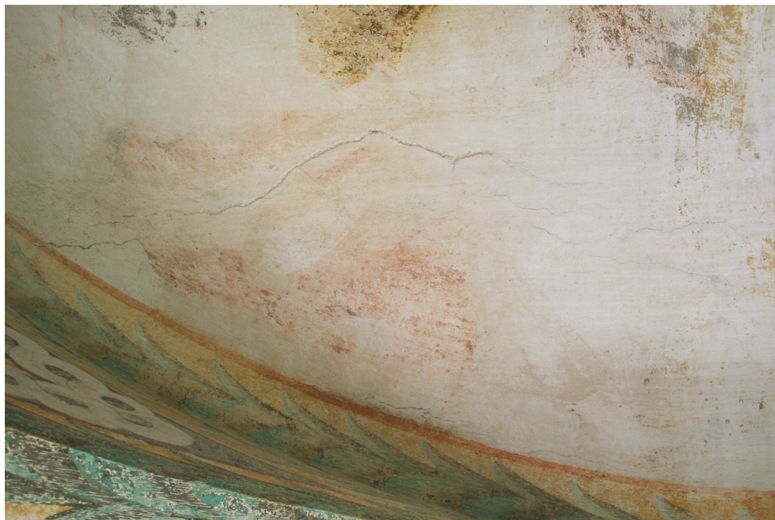
obr.16 - Lov na medvěda drobné prasklinky statického původu
