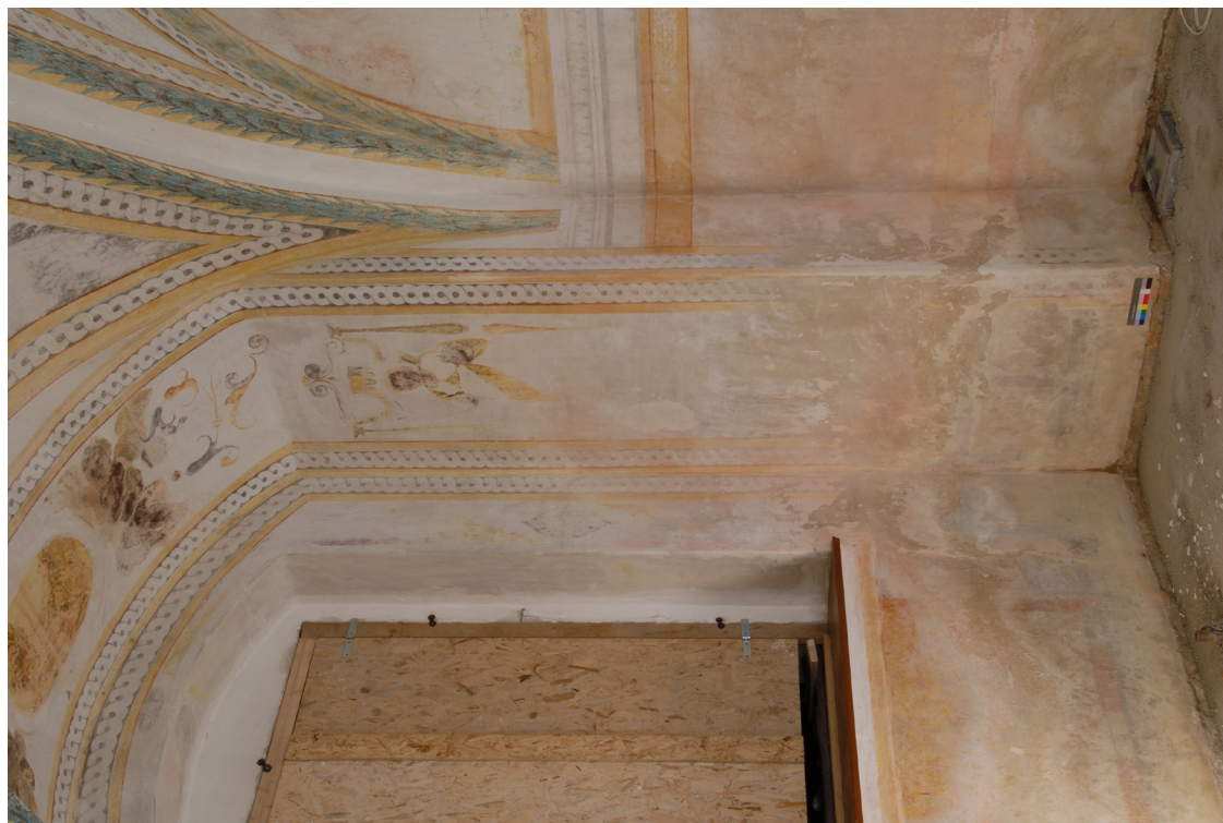
obr.20 - Severovýchodní roh místnosti - výrazně poškozen vlhkostí, solemi, patrný růžový povlak
