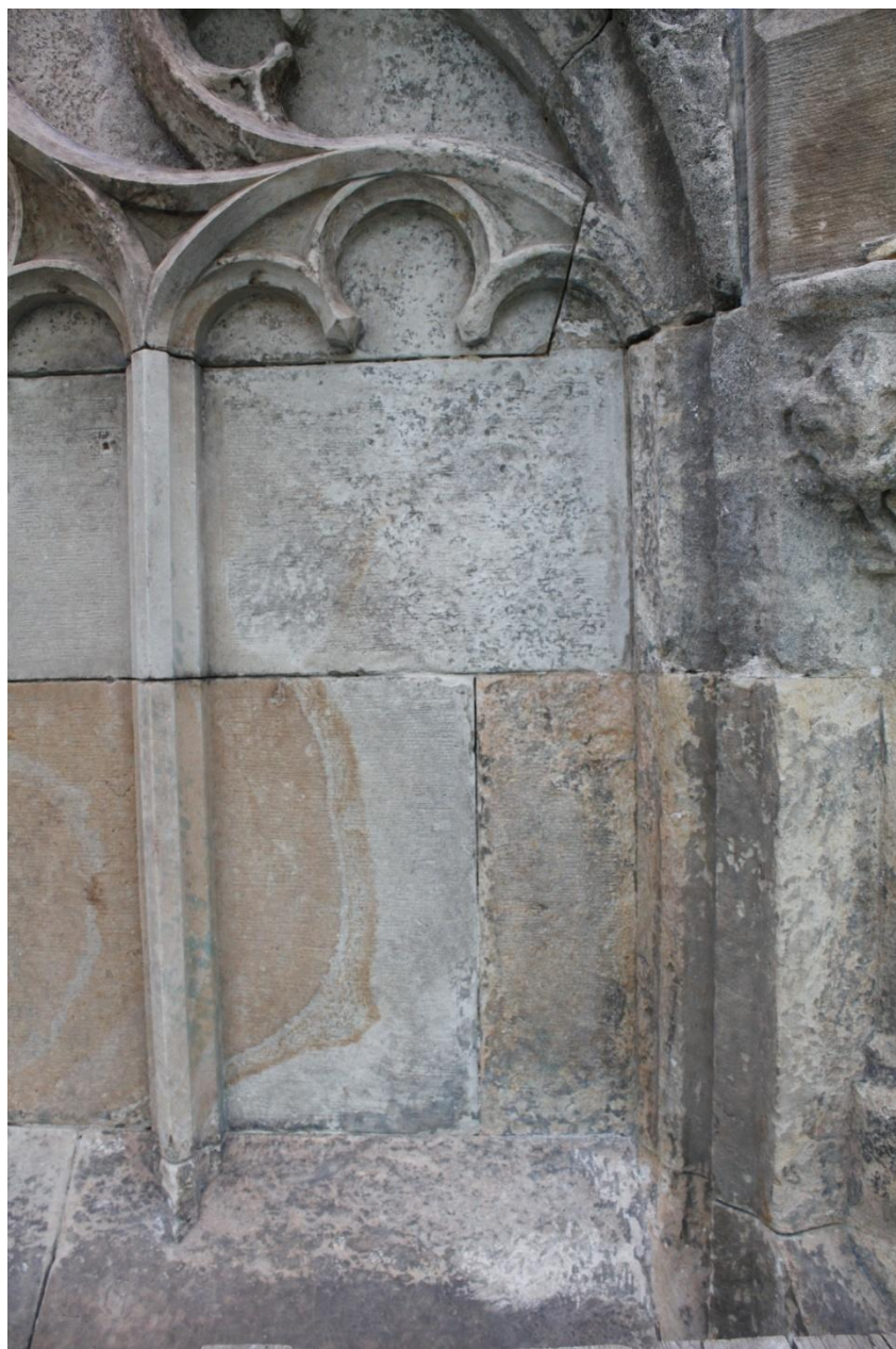
Kamenná kašna Kutná Hora, po odstranění tmelů, spár, povlaků a nátěrů, střední část, foto Jiří Helma
