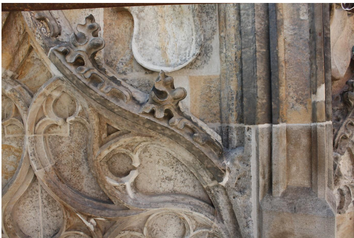
Kamenná kašna Kutná Hora, po vytmelení a vyspárování, střední pravá část, foto Jiří Helma
