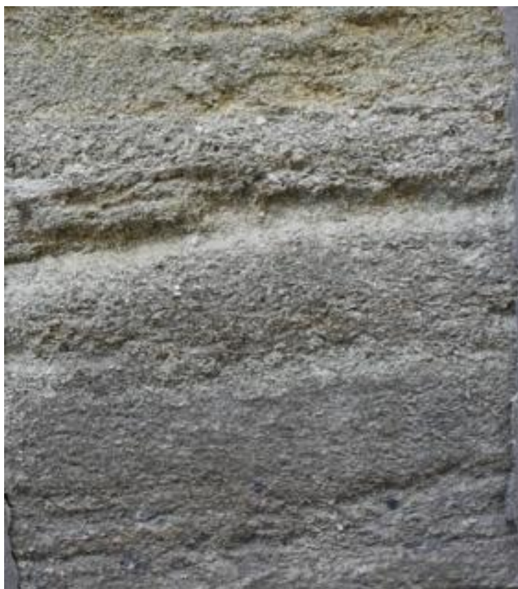
Obr. 41. Internát SPŠ. KH. čp. 67, budova první kutnohorské reálné školy z roku 1857. Vyplavená méně soudržná vrstva kutnohorského vápence.
