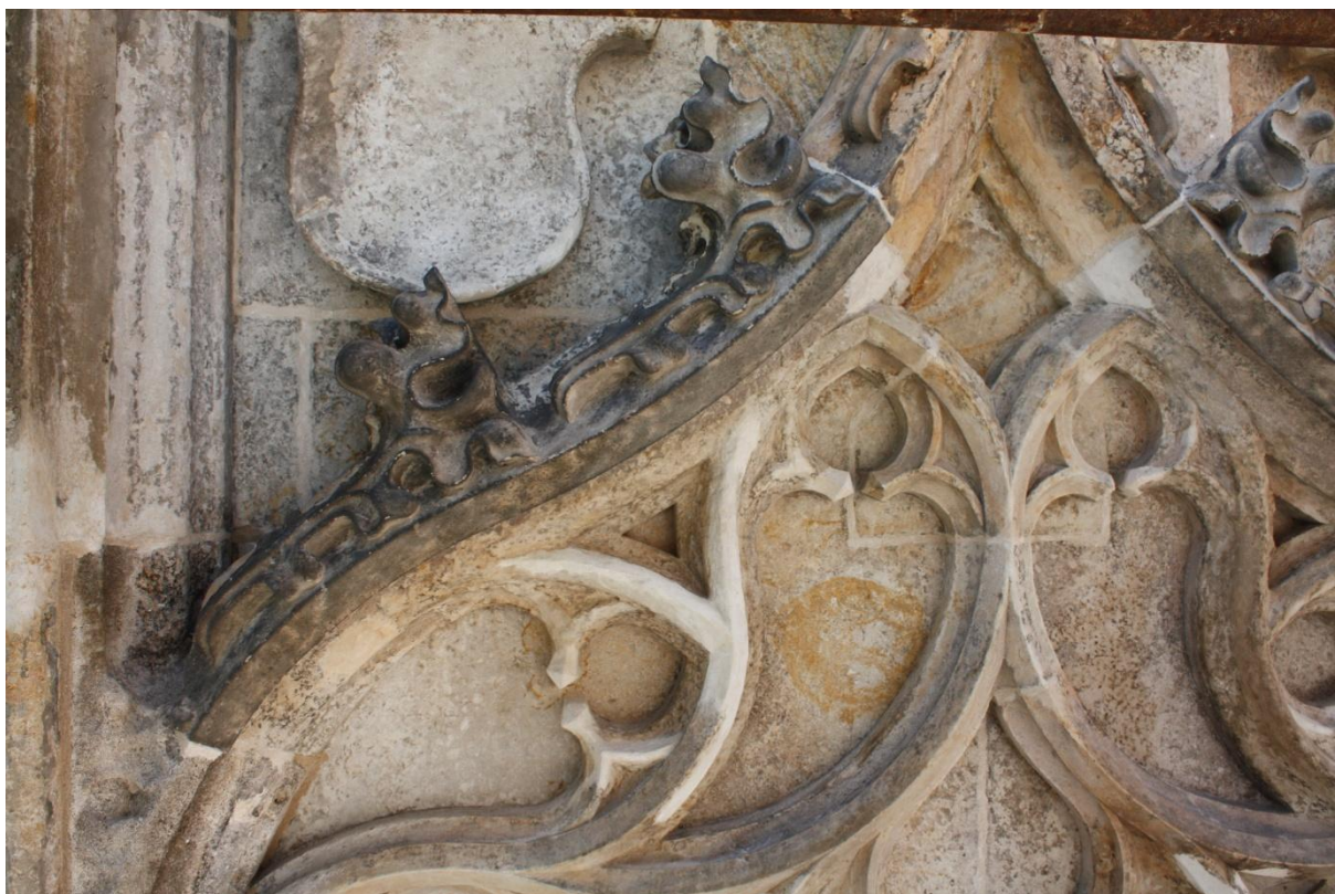
Kamenná kašna Kutná Hora, po vytmelení a vyspárování, střední levá část, foto Jiří Helma
