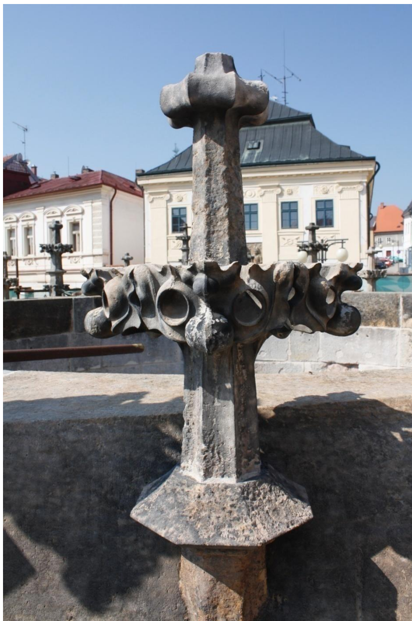
Kamenná kašna Kutná Hora, po vytmelení a vyspárování, středová vrcholová kytka, foto Jiří Helma
