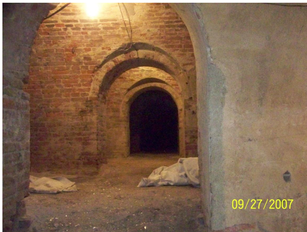
Obrázek č. 58: Fotografie vnitřku lunety. V každé kasematě byly tři střílny mířící těsně nad vrcholem suchého příkopu do prostoru shromaždiště (autor: z archivu firmy STAVEX Č+B s.r.o. 27. 09. 2011).
