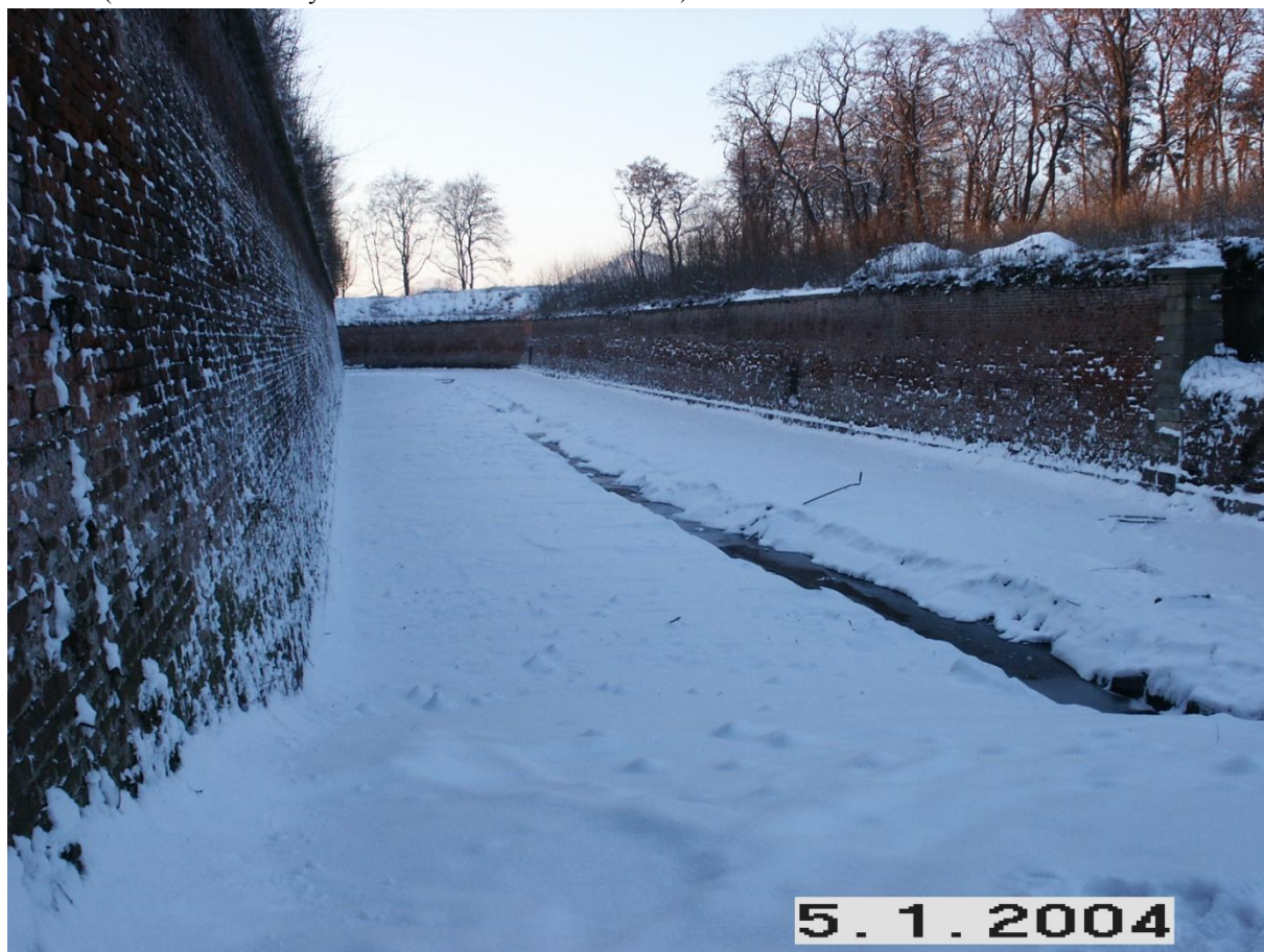
Obrázek č. 29: Fotografie příkopu před kontragardou č. XX, na levé straně je odklon od vertikály evidentní činil 1:6 (autor: archiv firmy STAVEX Č+B s.r.o. 5. 1. 2004).
