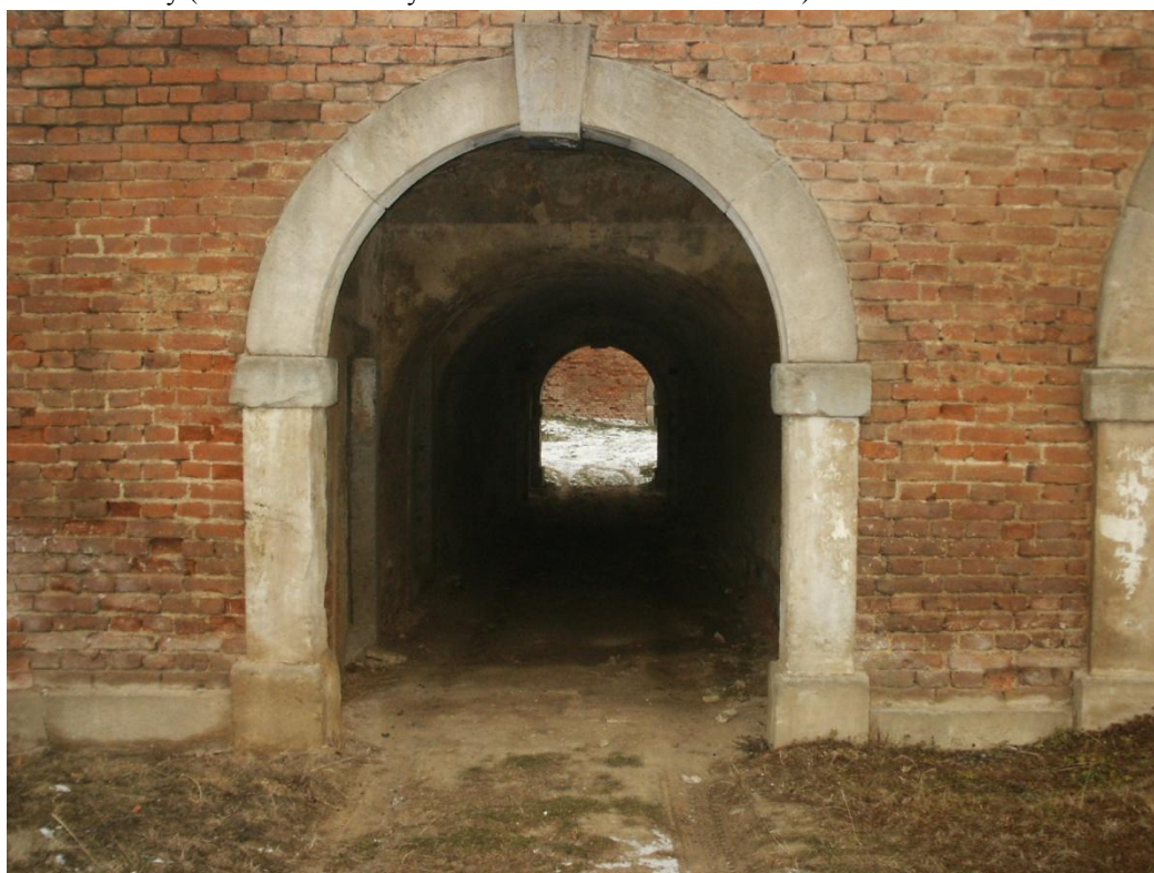
Obrázek č. 33: Jedna z potern v křídle reduty na ravelinu č. XVIII. Vlevo ihned za dveřmi se nachází prachárna a pár metrů dále jsou ve zdech vyvedeny zářezy, do kterých se zasouvala dřevěná prkna, aby se zesílila odolnost brány (autor: archiv firmy STAVEX Č+B s.r.o. 8. 1. 2008).
