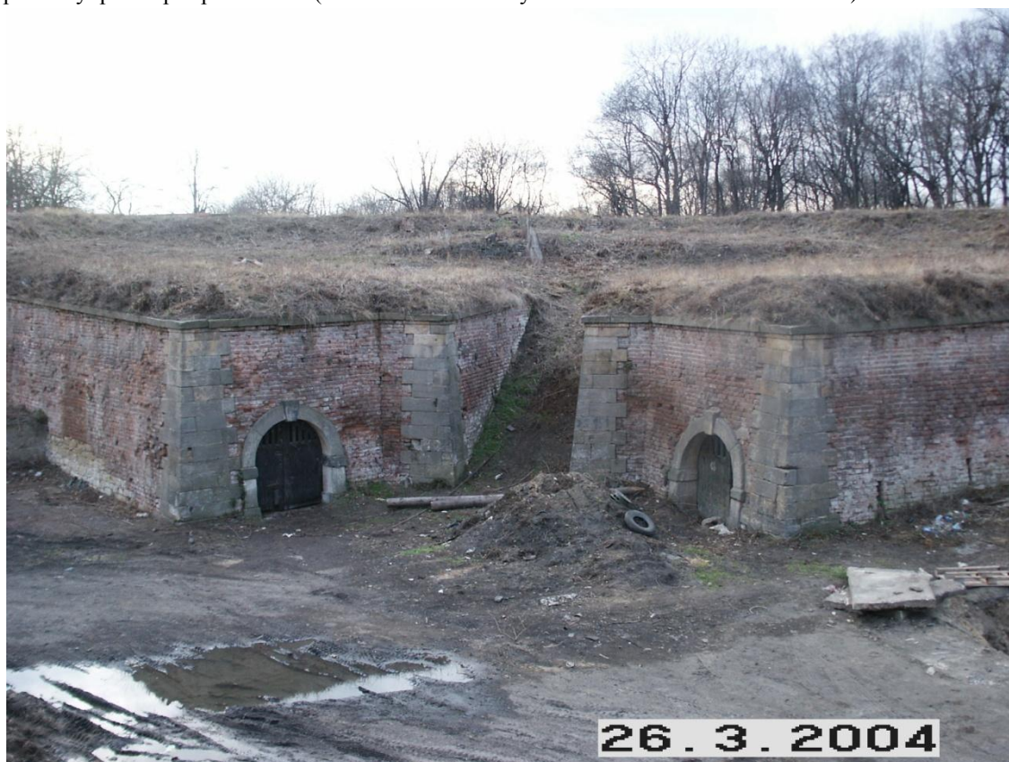
Obrázek č. 57: Na fotografii je zachycen tyl lunety (úroveň zeminy je o 1,8 m výše než původně), tento prvek byl pouze pro pěší střelce (autor: z archivu firmy STAVEX Č+B s.r.o. 26. 3. 2004).
