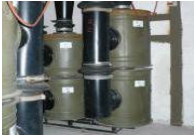
Obrázek 2 – Kolona kolektivních filtrů KF – 300
