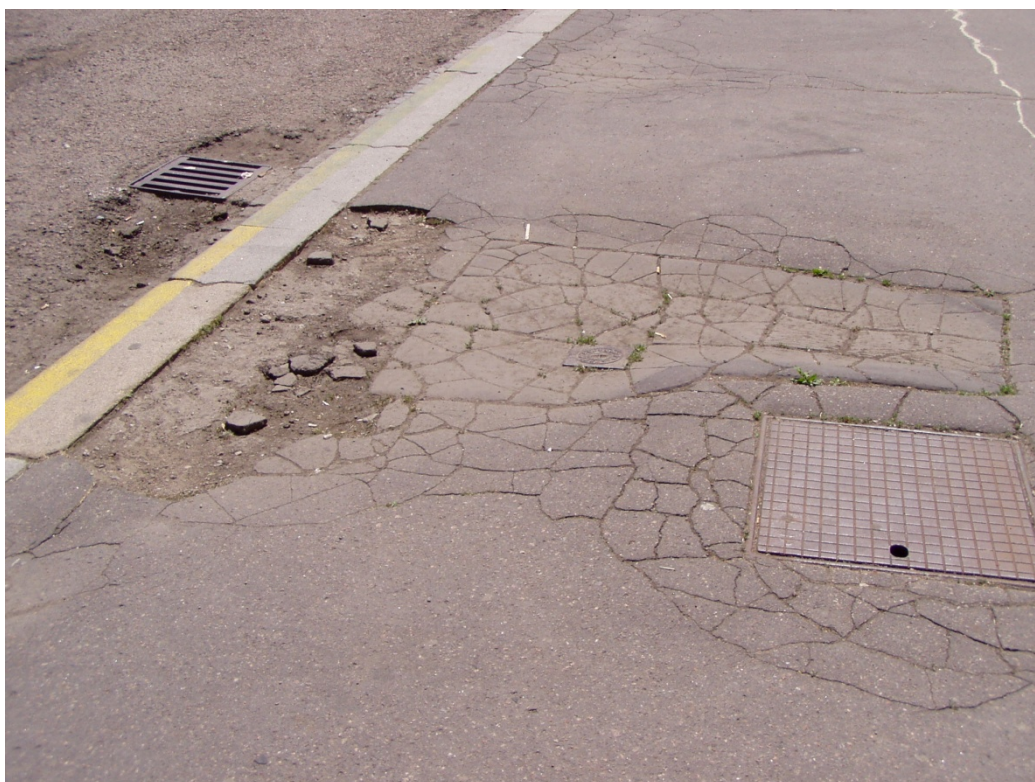
Obrázek 6 – Výtluk, způsobený mozaikovými trhlinami
