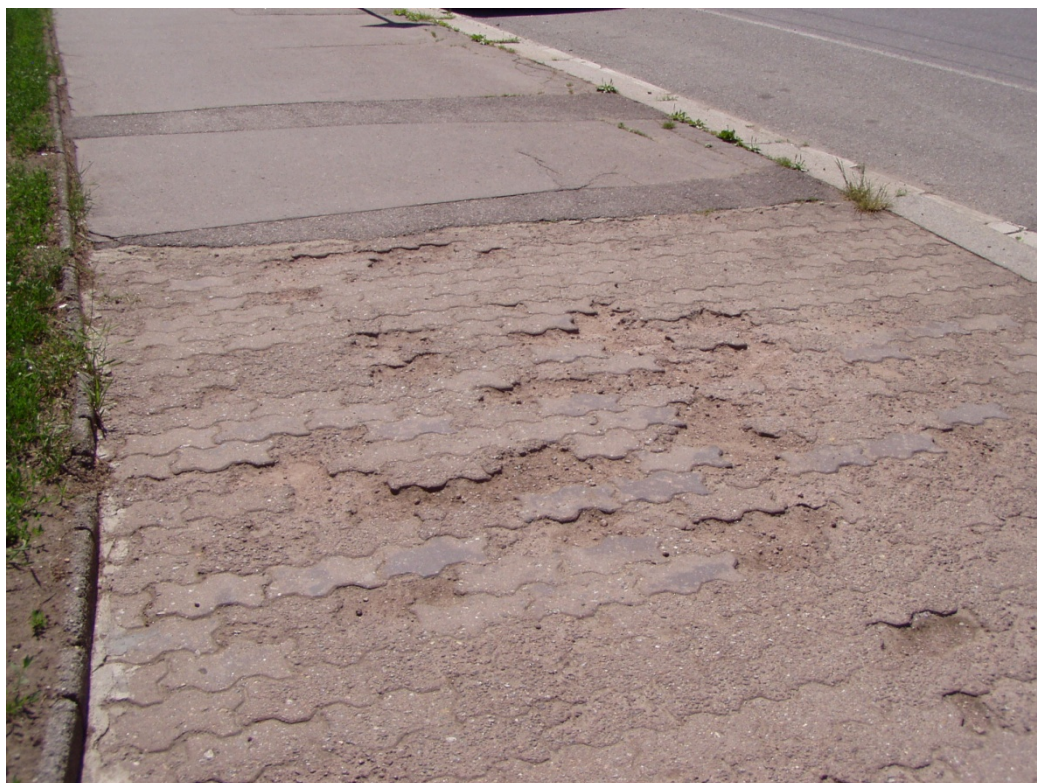
Obrázek 9 – Opotřebovaná zámková dlažba
