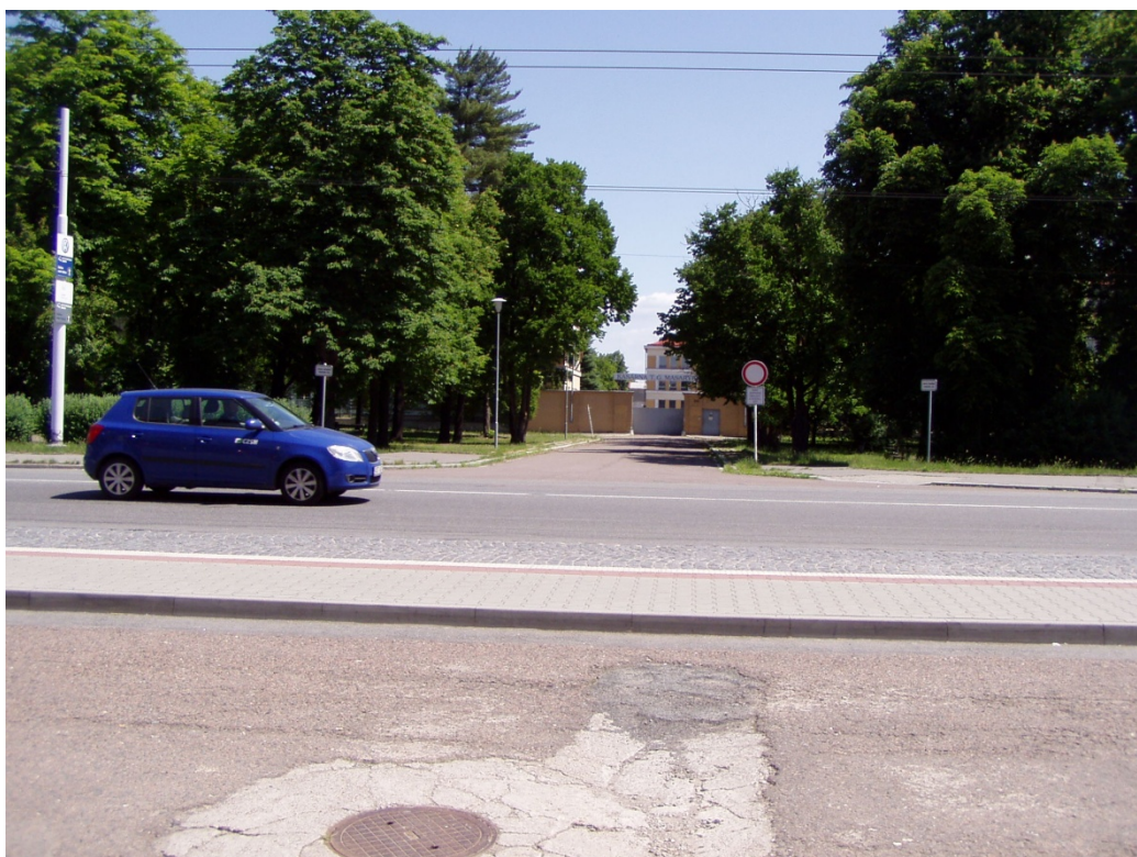
Obrázek 7 – Výtluk, způsobený mozaikovými trhlinami
