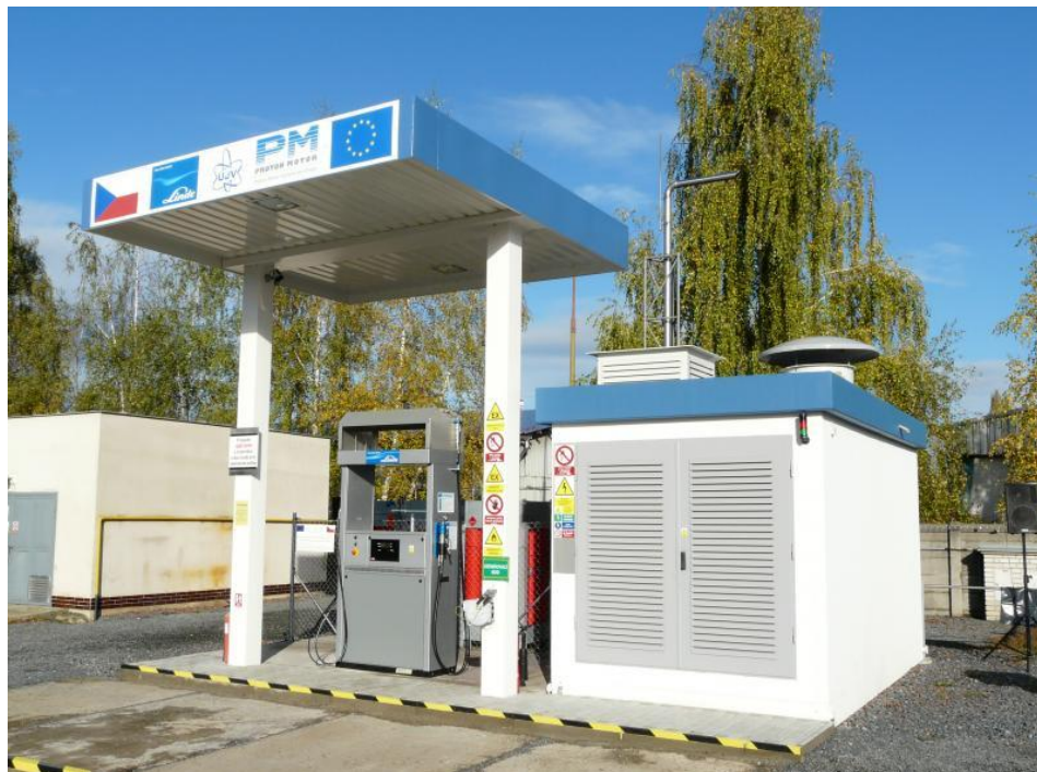
Obr. 4.15. Vodíková čerpací stanice [12]
