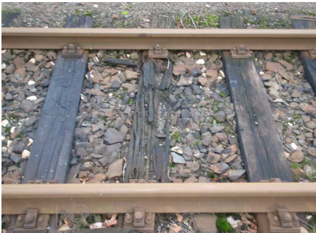
Obr. 21 Železniční svršek – kolejnice typu T, dřevěné pražce v dezolátním stavu
