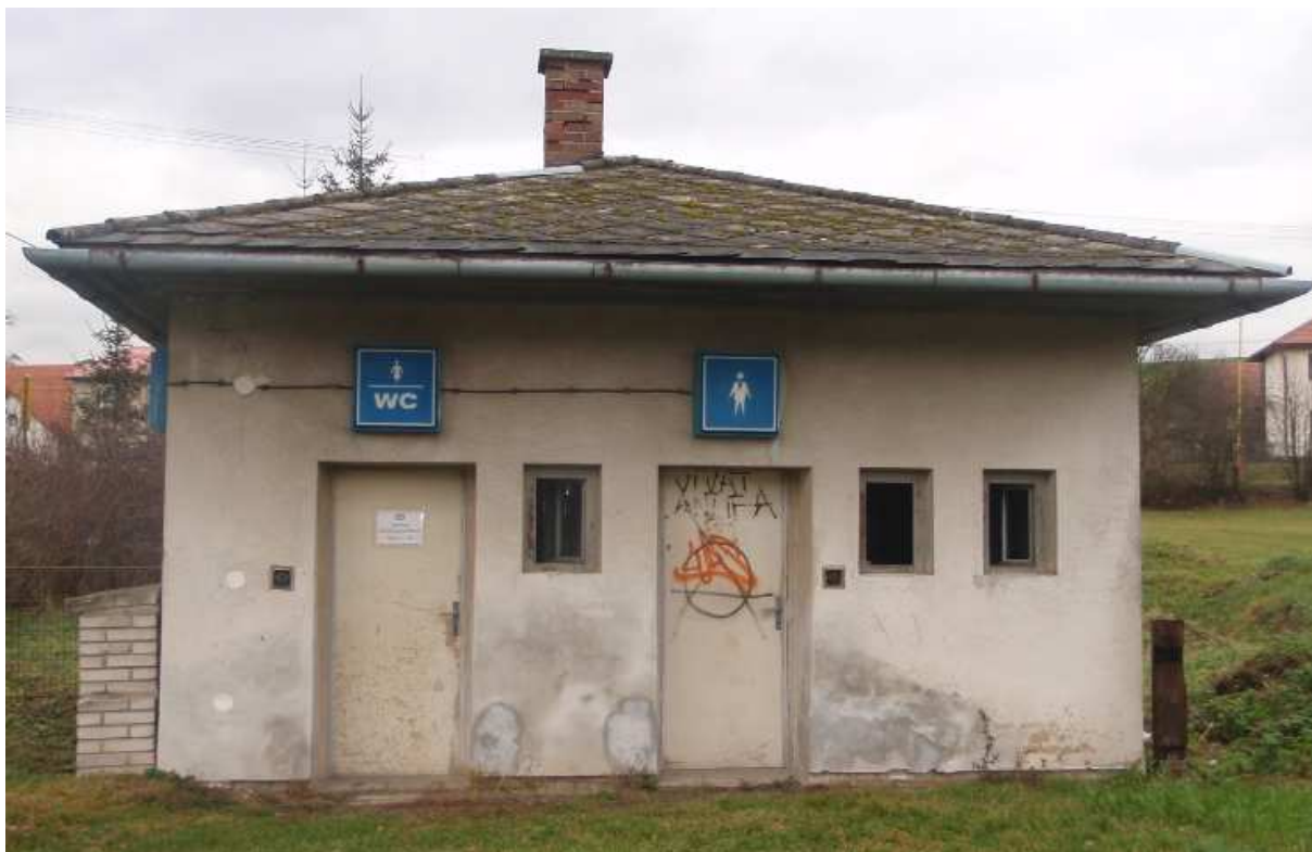
Obr. 5 Nevyhovující objekt se sociálním zařízením
