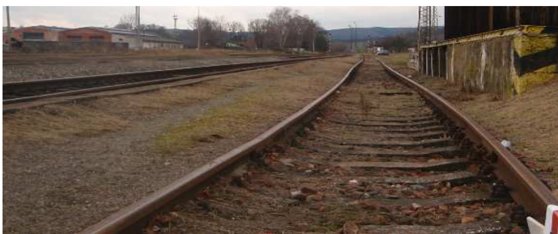
Obr. 22 Železniční svršek – okem viditelné geometrické odchyly v manipulačních kolejích
