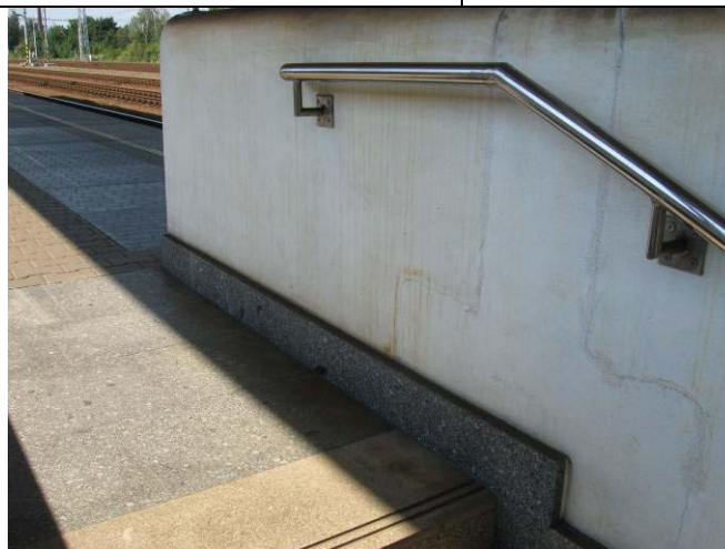
Obr.3.14.2.3: Chybějící hmatový pás
