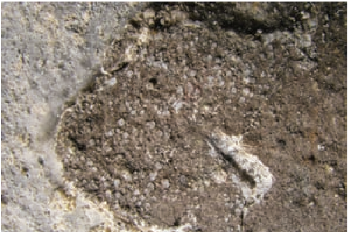
43. Krystalická eflorescence na barokní omítce (S1)
