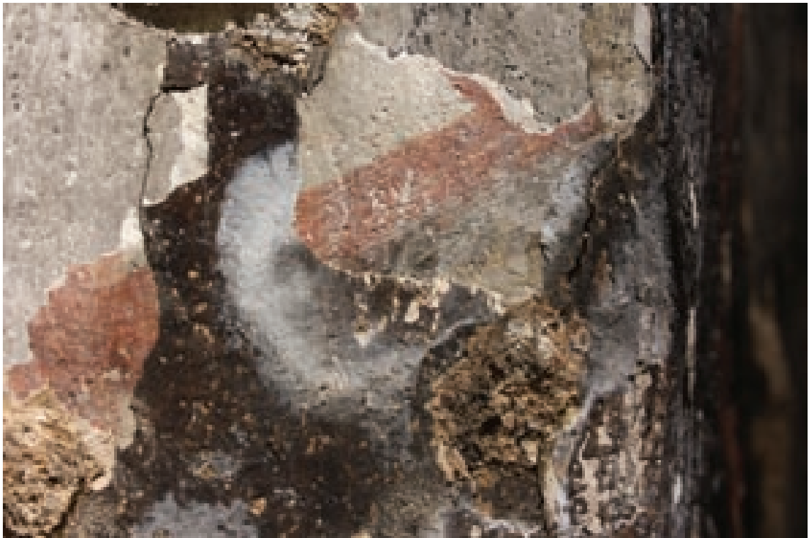
42. Bílý zákal na gotické omítce v pravé části okenní špalety způsobený pravděpodobně činností vodorozpustných solí
