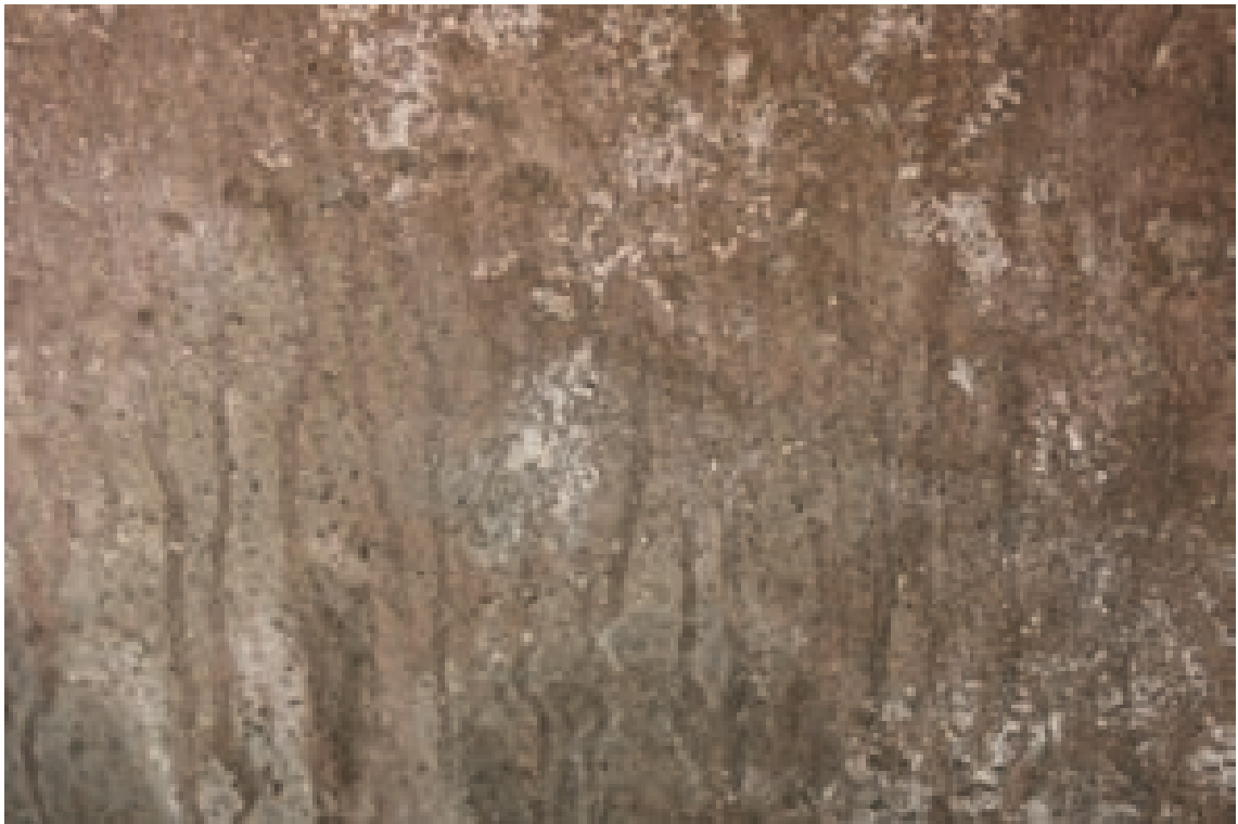
38. Stopy po kondenzaci na barokní omítce
