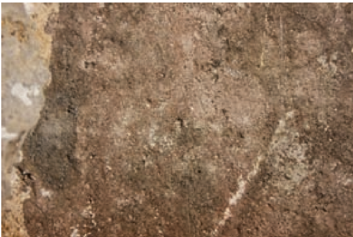
32. Růžová bakterie vyskytující se na barokní omítce východní stěny (V3)
