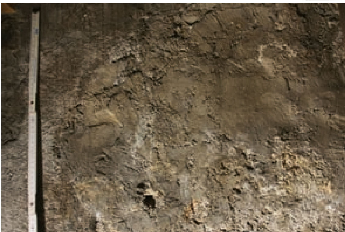
27. Novodobá vysprávka ve spodní části východní stěny dosahující do výšky cca 2 m
