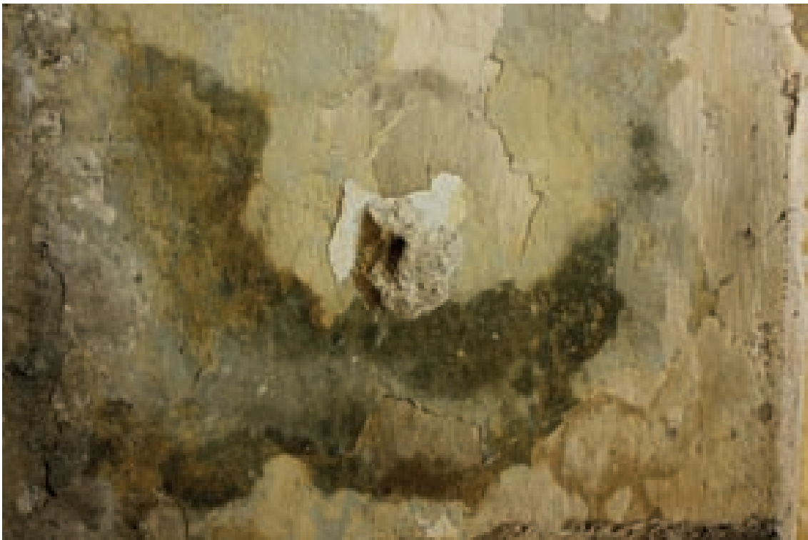
37. Vlhká mapa v místě po odstranění heraklitové desky při pravém okraji východní stěny
