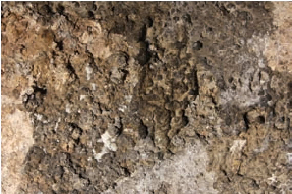
47. Šedá křusta krápníkovité struktury se suchým a tvrdým povrchem na barokní omítce (S5)
