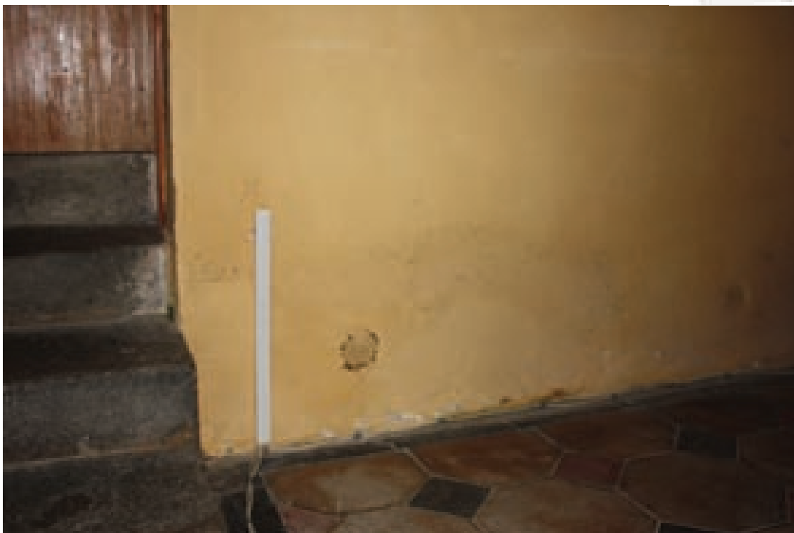
33. Pohled na severní stěnu mezi presbyteriem a sakristií. Větrací systém ze 60. let 20. století tvořený otvory krytými dřevaným plechem. Ve spodní části stěn se nacházejí omítnuté heraklitové desky, ve kterých se drží vlhkost, což vede k napadení plísněmi, které je patrné i na povrchu omítek.
