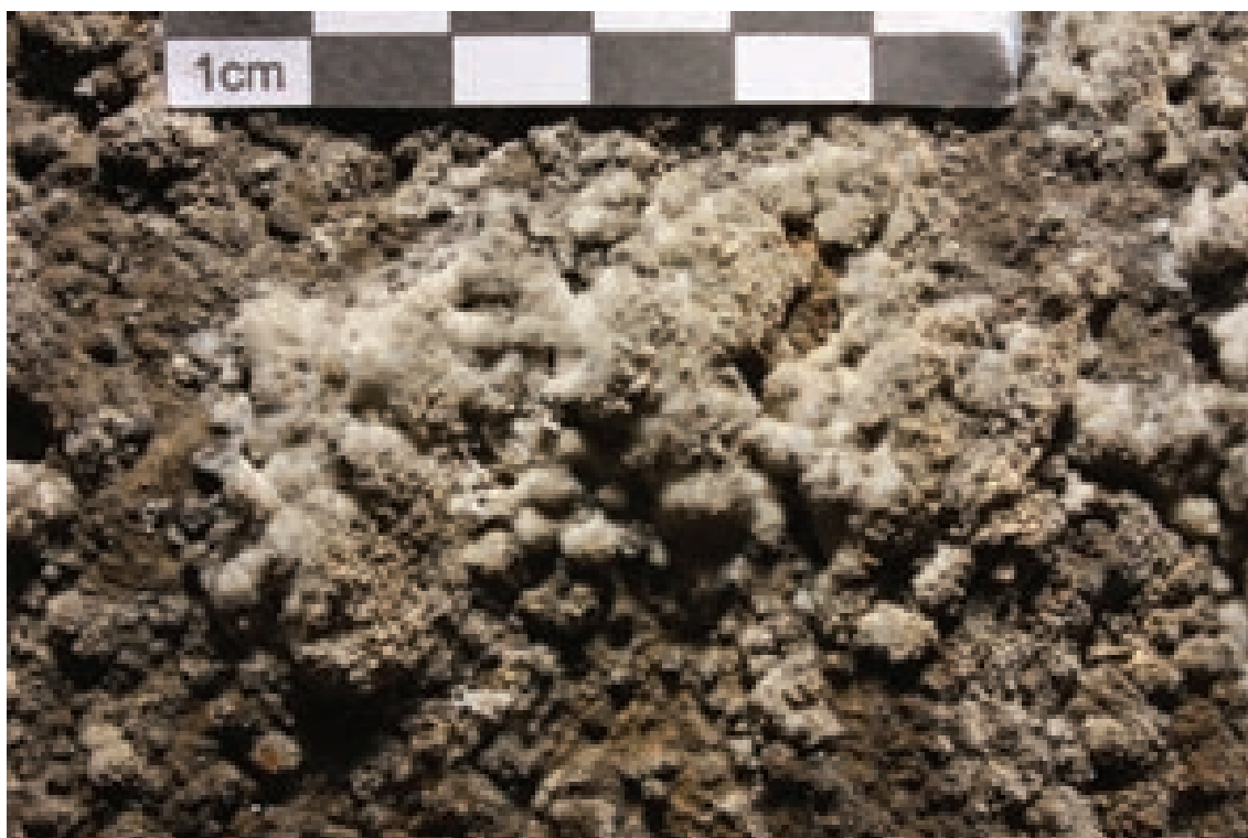
44. Kompaktní bílá eflorescence na barokní omítce (S2)
