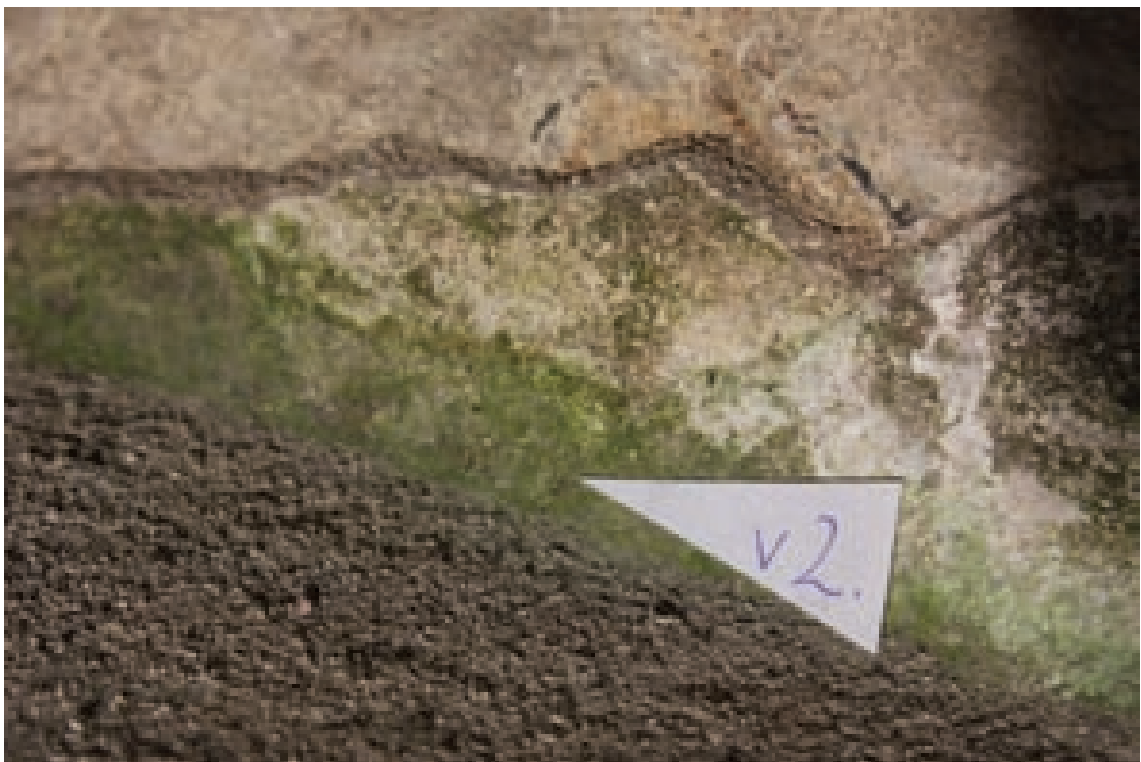
31. Zelená řasa v místě styku svislé stěny okenní špalety a parapetu (V2)
