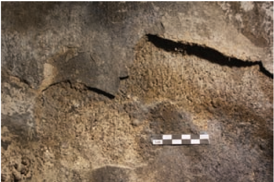
39. Poškození barokní omítky způsobené činností vodorozpustných solí
