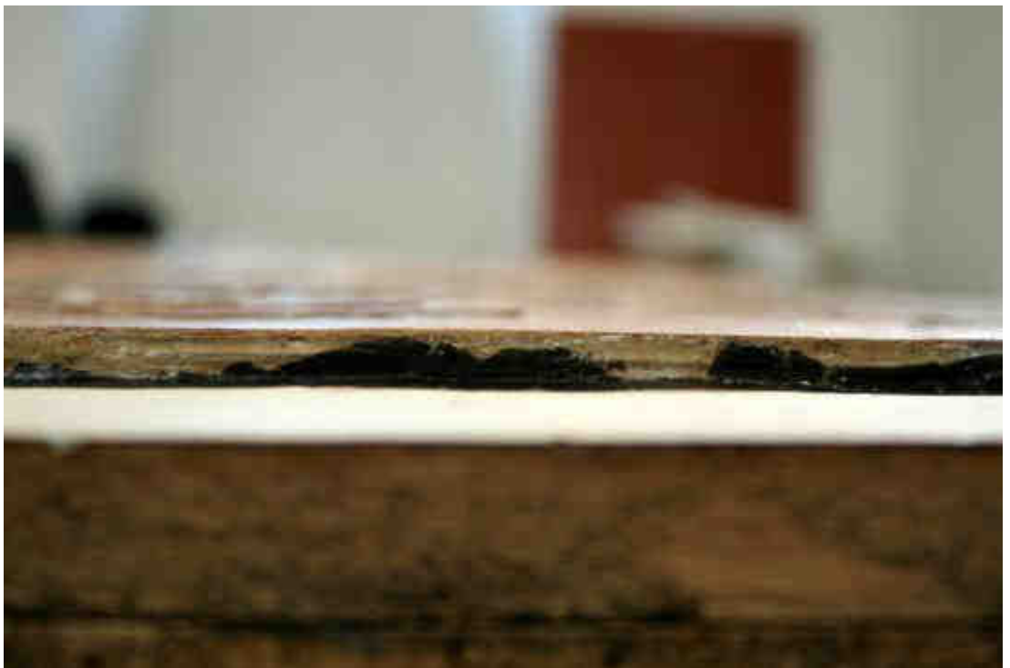
Obr. č. 107: Stav po tmelení hrany voskem, boční detail, denní rozptýlené světlo.
