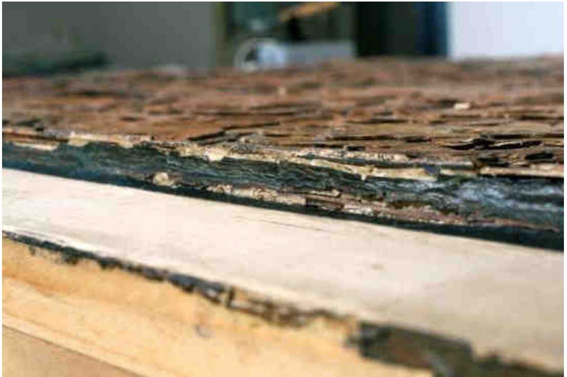
Obr. č. 78: Stav po vyrovnání, boční detail, denní rozptýlené světlo.
