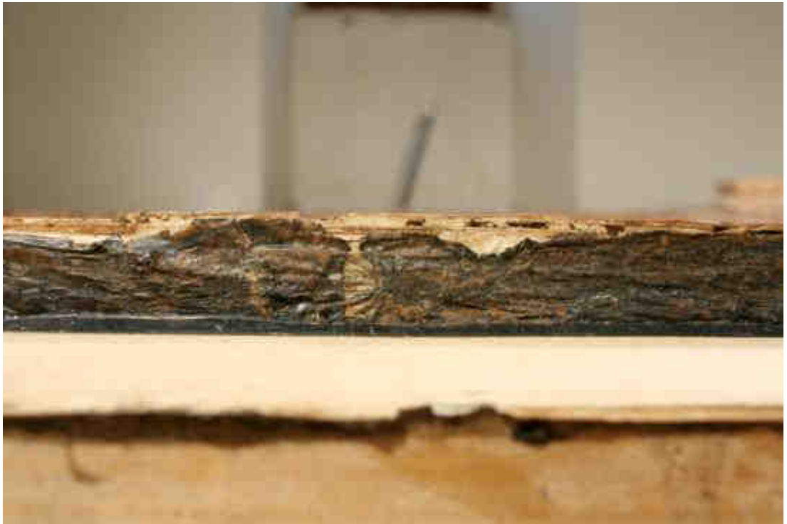
Obr. č. 84: Stav po vyrovnání, boční detail, denní rozptýlené světlo.
