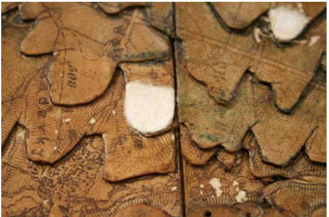
Obr. č. 125: Stav po tmelení lepenek, detail, denní rozptýlené světlo.
