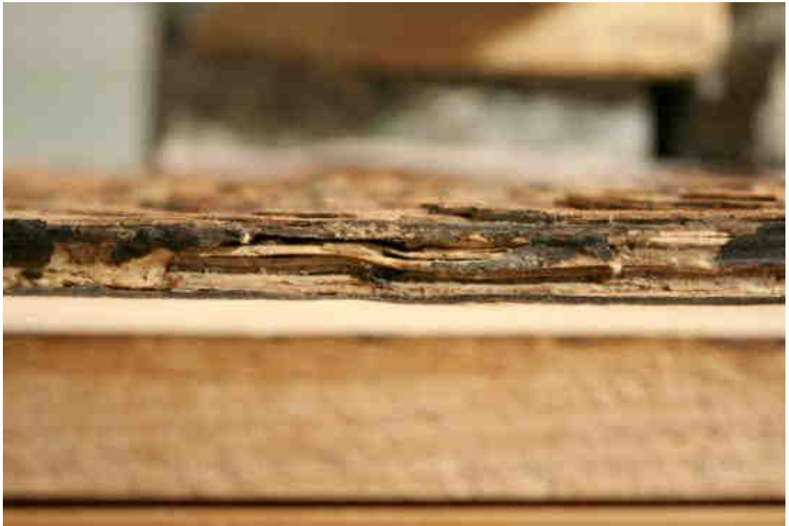
Obr. č. 80: Stav po vyrovnání, boční detail, denní rozptýlené světlo.
