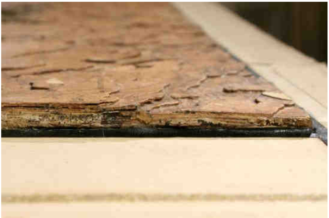
Obr. č. 87: Stav po vyrovnání, boční detail, denní rozptýlené světlo.
