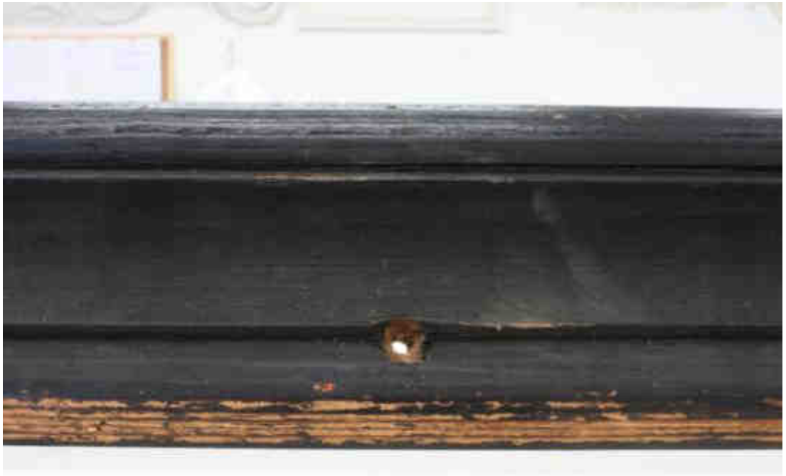
Obr. č. 52: Stav před restaurováním, detail rámu, denní rozptýlené světlo.
