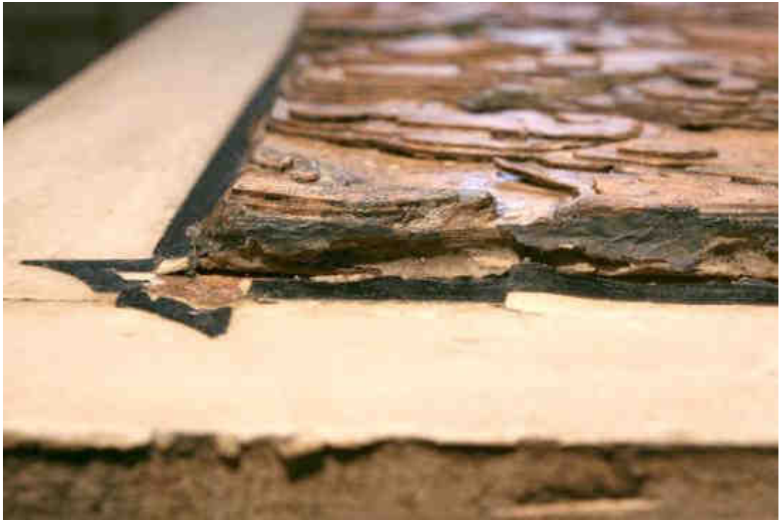
Obr. č. 82: Stav po vyrovnání, boční detail, denní rozptýlené světlo.
