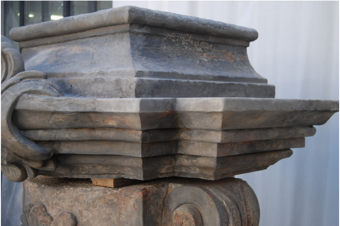
Obr. 69 - Roh hlavice - stav po restaurování
