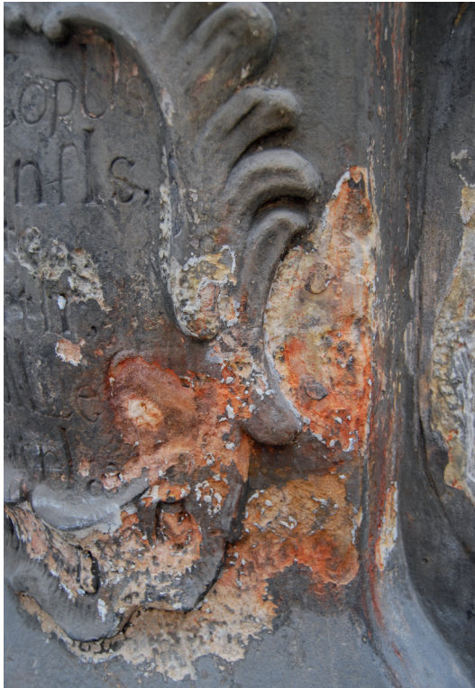
Obr. 15 - Detail povrchové koroze
