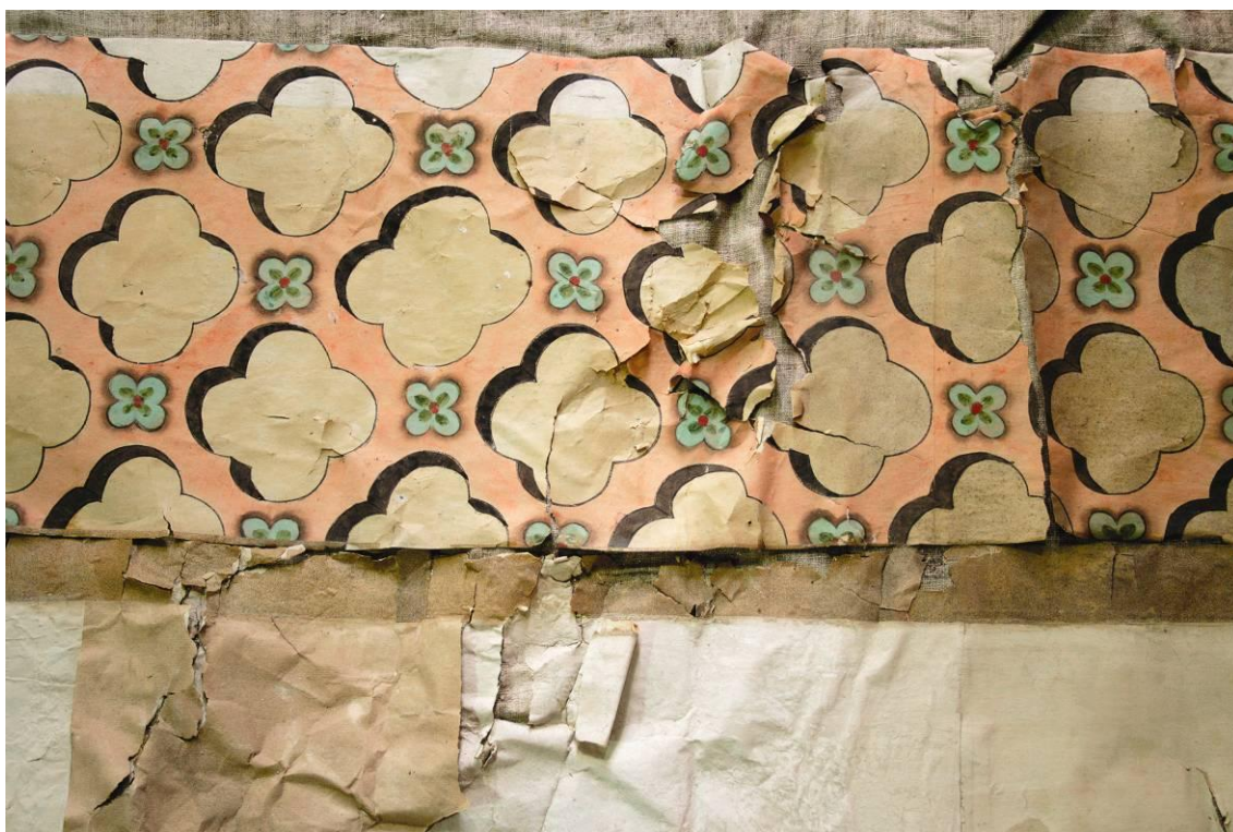
Obr. 19 – Detail poškození bordury
