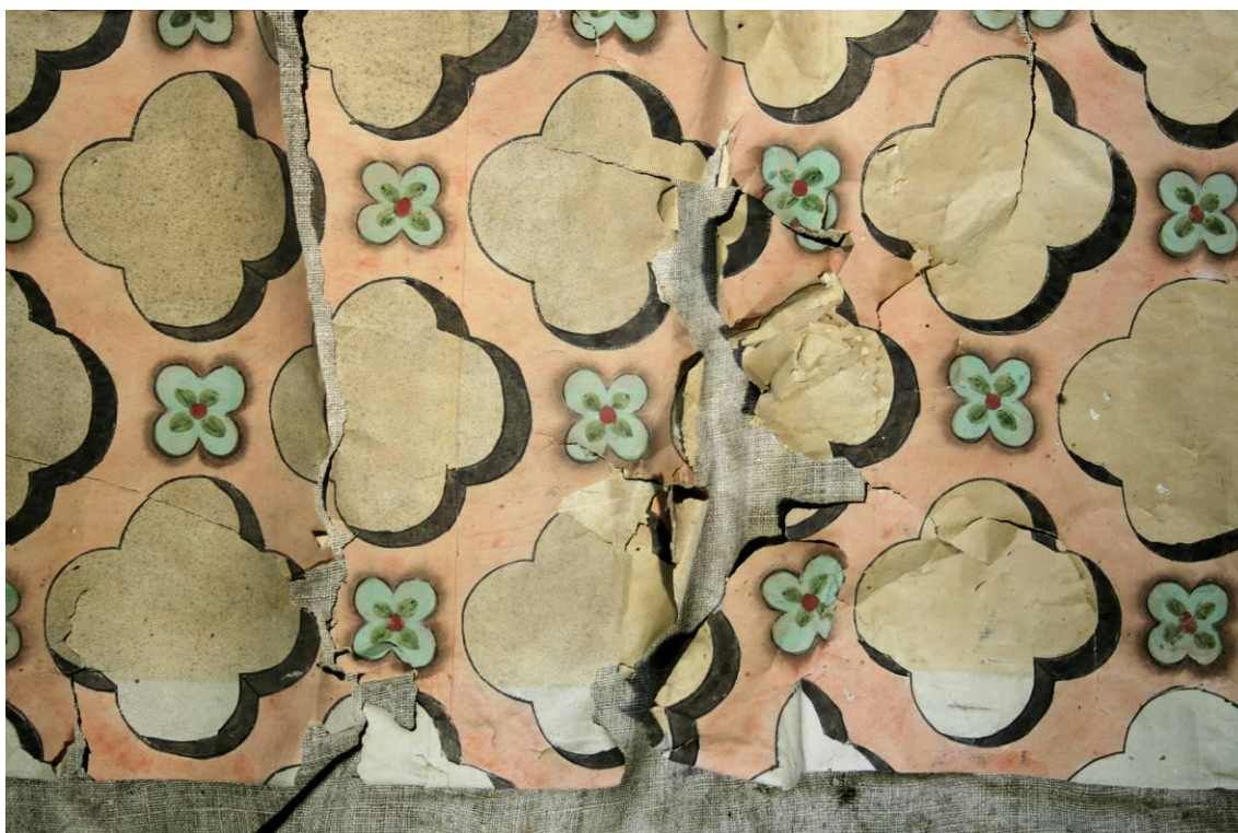
Obr. 62 – Detail poškození bordury
