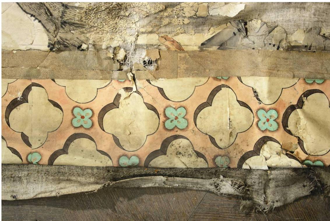
Obr. 20 – Detail poškození bordury
