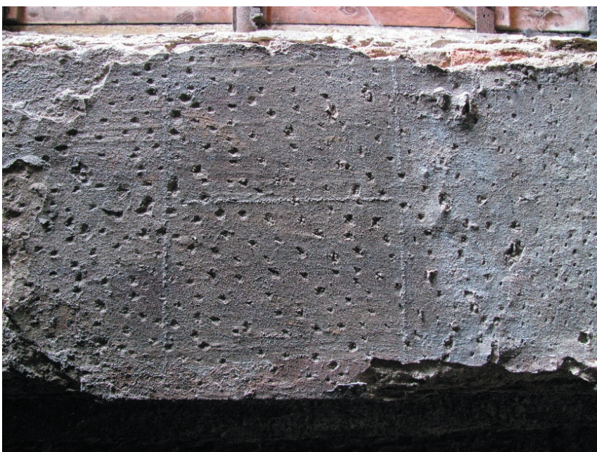
Zámek Ploskovice, grotty v suterénu objektu. Omítky destrúované vlivem působení vodoroz- pustných soli.
