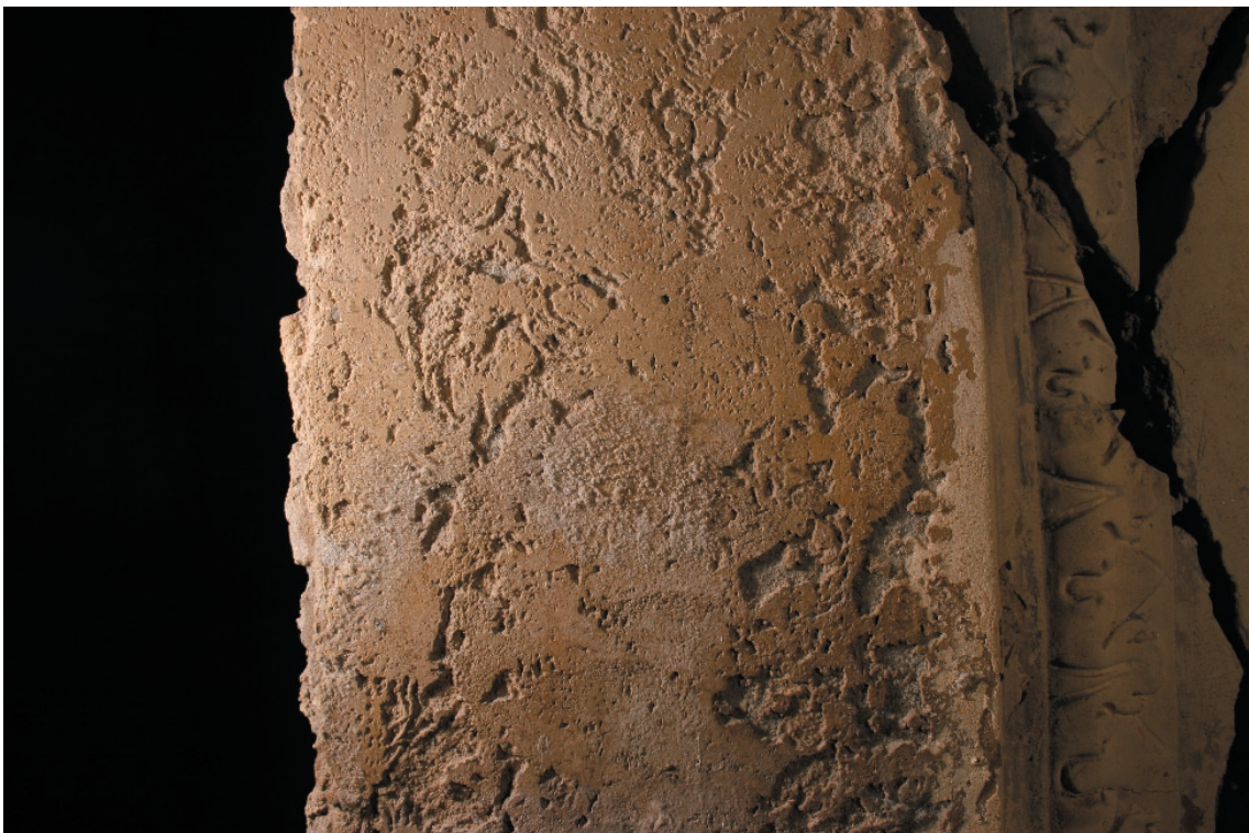
Zámek Hellbrunn, Ruinengrotte. Různé projevy působení vodorozpustných solí.
