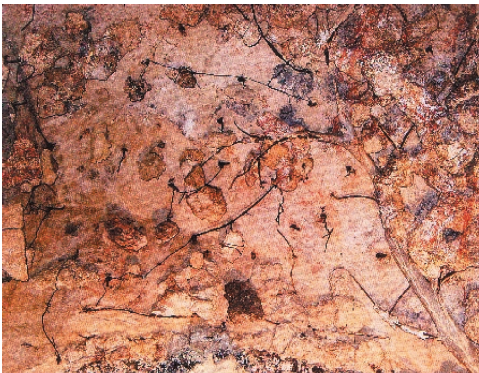
Zámek Kroměříž, salla terrena, Apollónova grotta. Obnažená kovová konstrukce imitace stromu. Reprofoto. Zdroj: Werkmann, Ladislav, Kroměříž – Arcibiskupský zámek, Neptunova grotta, Restaurátorský průzkum a projekt restaurátorského zásahu. 2008.
