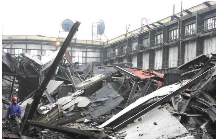
Obr. 6: Zřícená střecha kotelny
