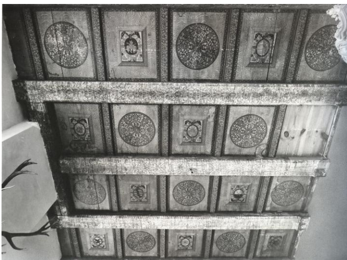
Obr. 1 Výzdoba stropu na zámku Annaburg, u Torgau, rekonstrukce originálního stavu
