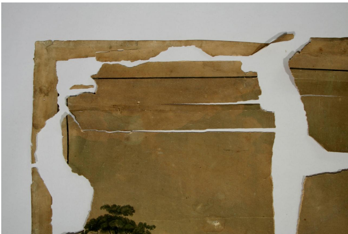
Obr. č. 3: Stav před restaurováním, detail poškození, průzkum v denním rozptýleném světle
