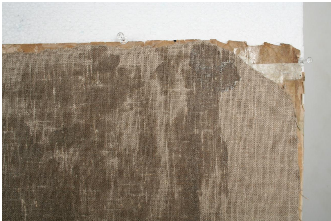
Obr. č. 27: Stav před restaurováním, detail poškození z reversu, průzkum v denním rozptýleném světle.
