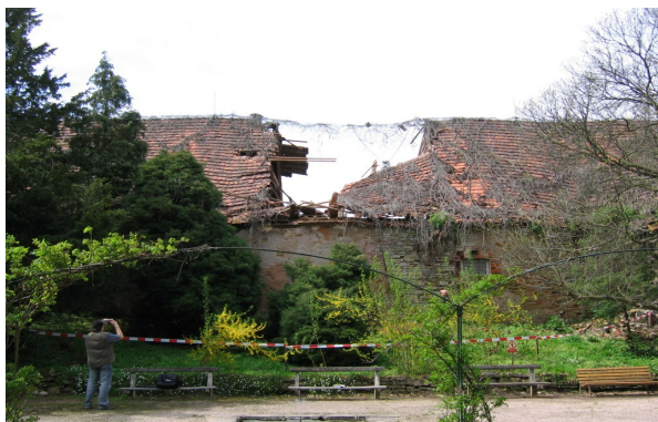
12. Chlív – z propadlého krovu zůstal pouze popínavý břechťan, 4. 5. 2005
