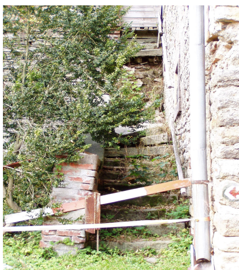
20. Zřícené schodiště (u stodoly), 2003
