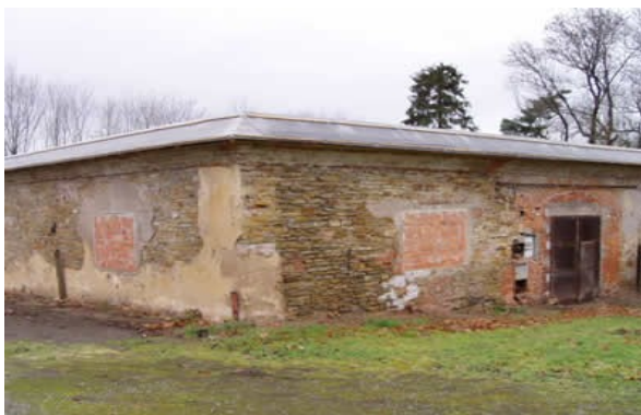
11. Koruna zdiva na stodole zabezpečena provizorním „bedněním“, 18. 11. 2004
