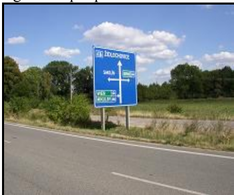
Agresivní podpěrné konstrukce
