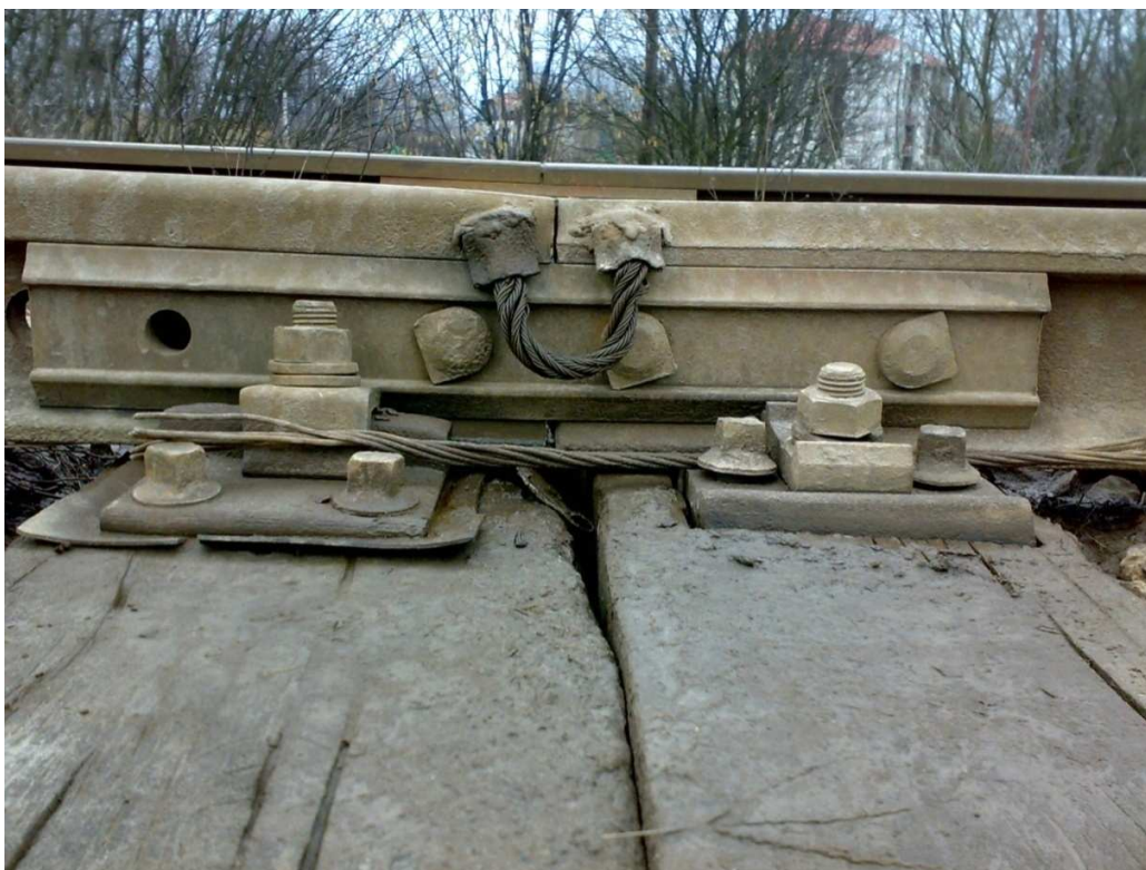
Obr. 12 Ukázka sjetí styku v místě elektrovodného styku
