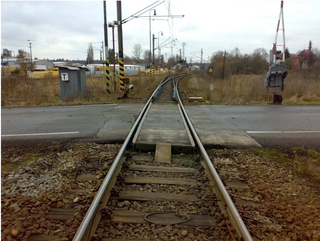
Obr. 3 Výhybka č. 1 s evidentním převýšením v oblouku a bezprostřední blízkosti přejezdu
