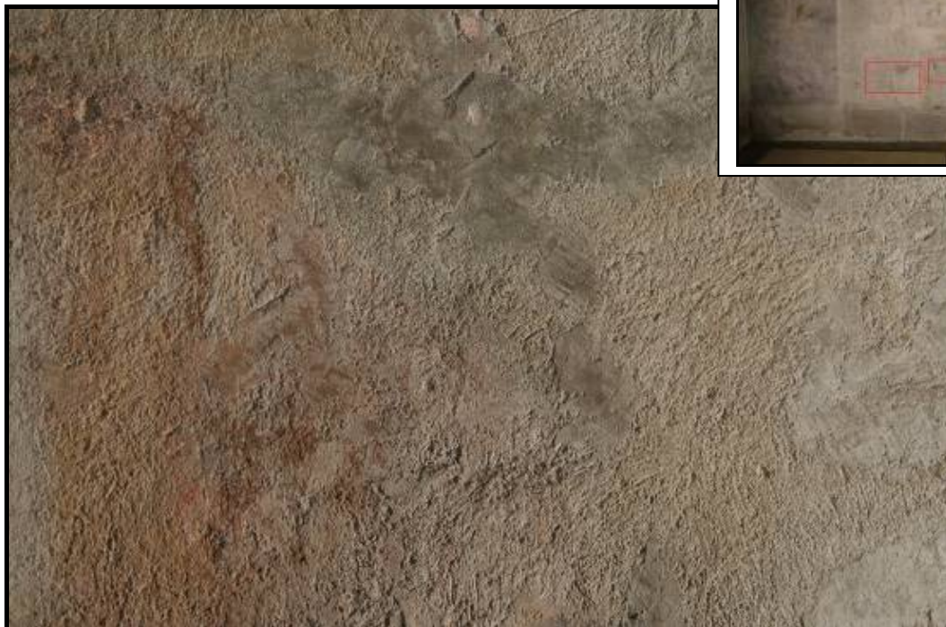
Obr. č. 9 Detail novodobého tmelu s bílým zákalem, stav před restaurováním; centrální výjev; severní stěna
