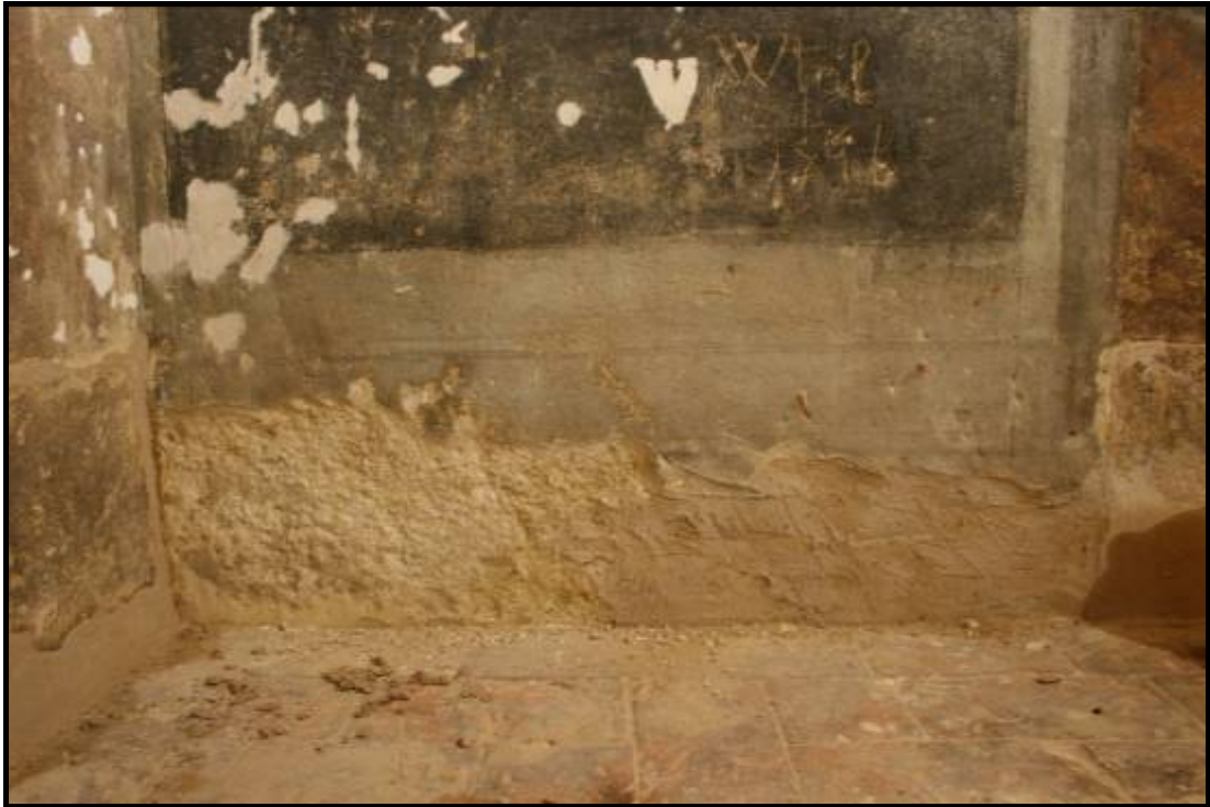
Obr. č. 45 Chybějící část patky pilíře, v místech kde ztráty byly až na zdivo, již zakryta vyrovnávací omítkou
