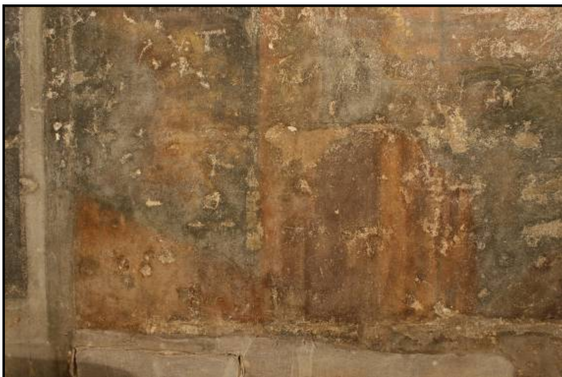
Obr. č. 23 Mechanická poškození – vrypy, škrábance, historická graffiti; chybějící barevná vrstva; místa s bílým zákalem
