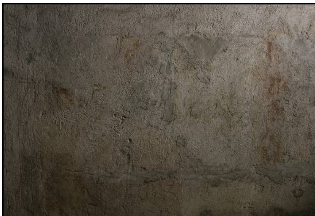
Obr. č. 10 Druhotné novodobé doplňky - tmely, stav před restaurováním; centrální výjev; severní stěna
