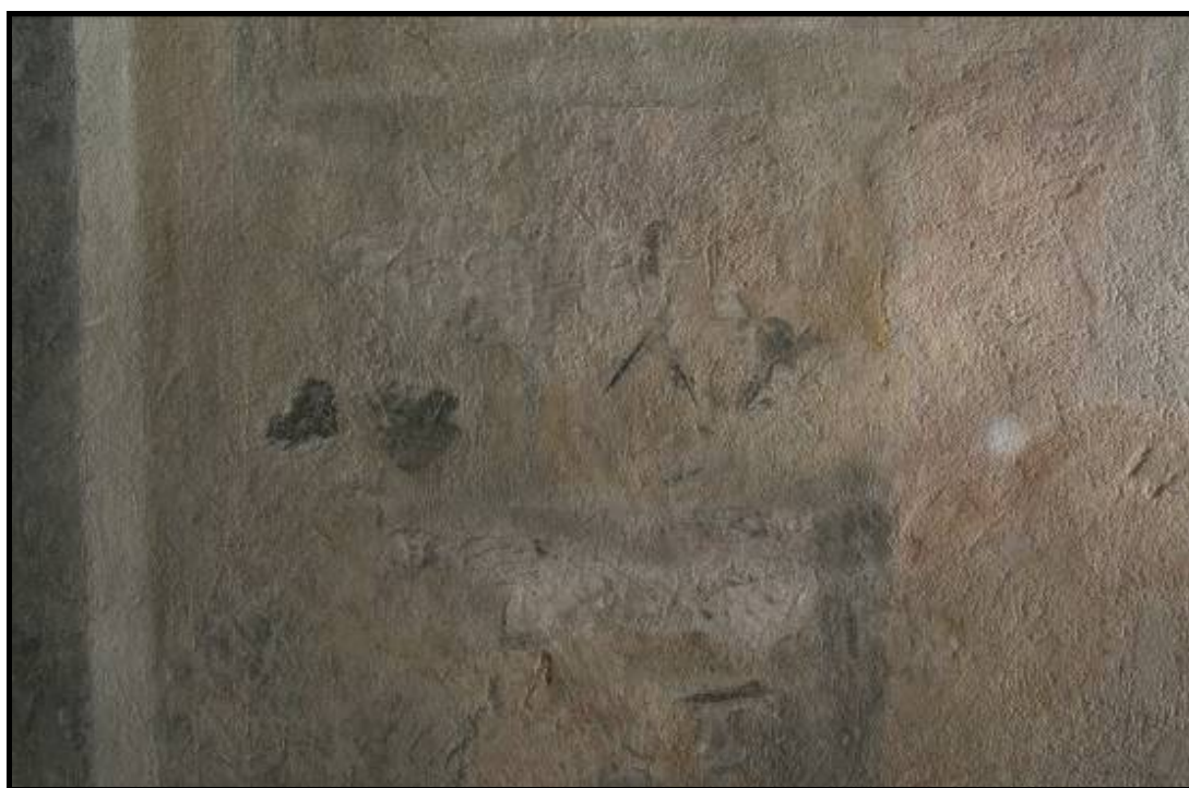
Obr. č. 8 Detail novodobého tmelu s bílým zákalem, stav před restaurováním; centrální výjev; severní stěna
