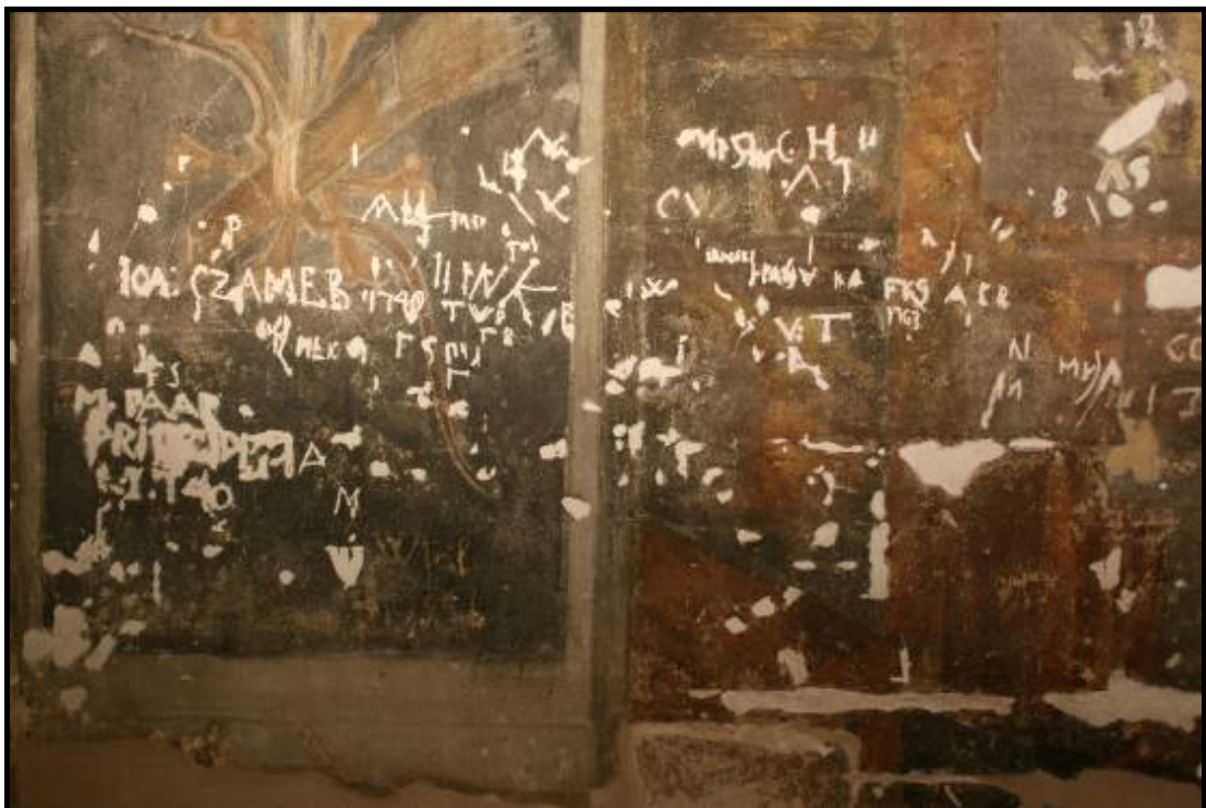
Obr. č. 51 Průběh tmelení – část pilíře a centrálního pole – zakrytí historických graffiti, škrábanců, oděrek, chybějících částí hmoty omítky
