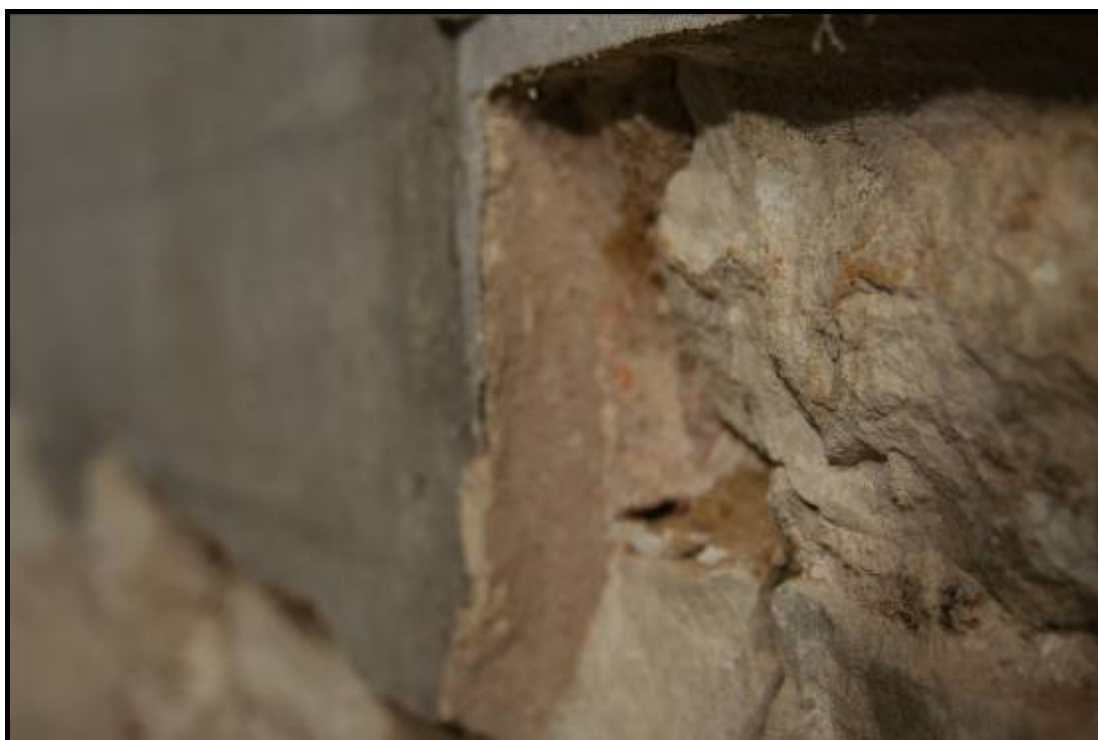
Obr. č. 30 Detail obtmelování okrajů spodních částí malby
