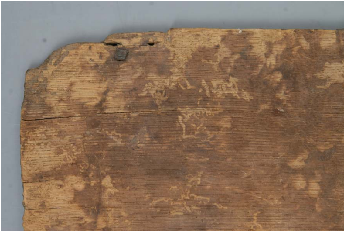
(Obr. 74) Detail poškození rohu desky
