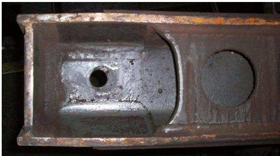
Obr.:42. Viditelné opotřebení nosníku při vzájemném kontaktu s torzní vzpěrou
