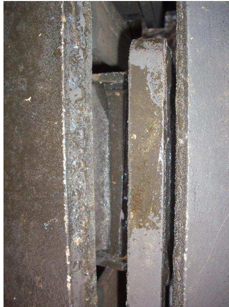
Obr.:26. Vzájemné posunutí těles spojky od jmenovité polohy
