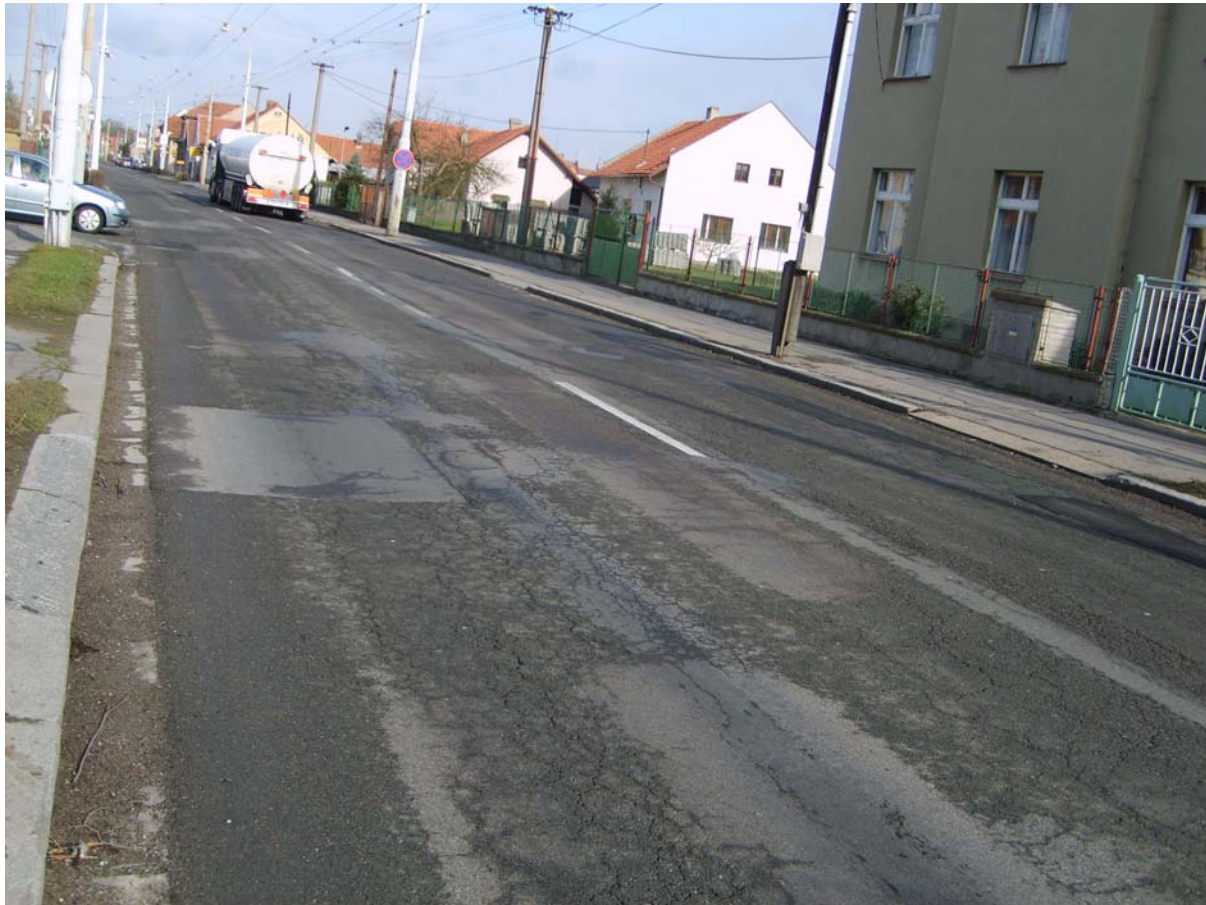
Obr. 4 Silnice I/36 současný stav krytu vozovky
