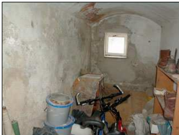
Obrázek 6: Boční pronikající vlhkost. Zdroj [5]
