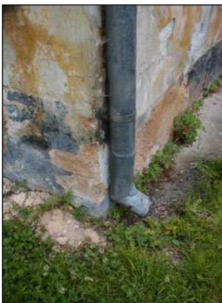
Obrázek 9: Vlhkost následkem stavebních poruch. Zdroj[5]
