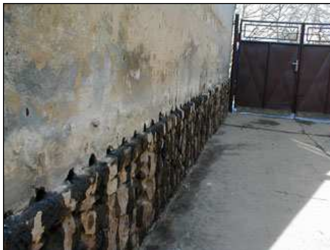
Obrázek 14: Nevhodné stavebně technické zásahy. Zdroj [5]
