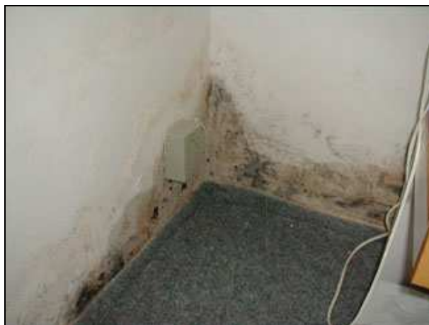
Obrázek 13: Kondenzační vlhkost. Zdroj [5]
