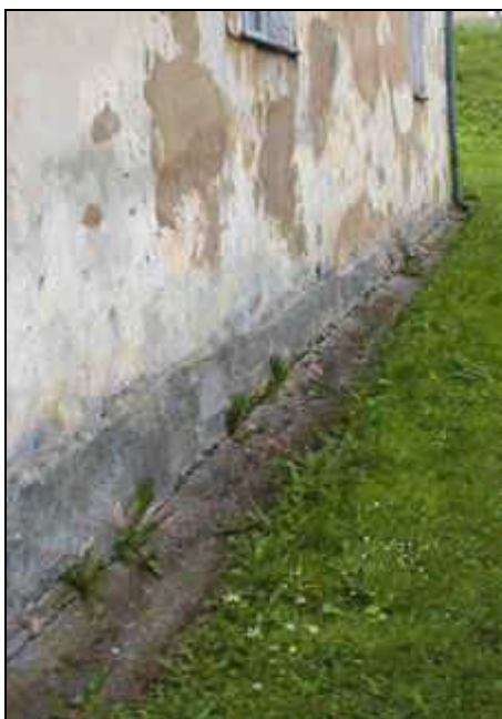
Obrázek 11: Vsakovací vada. Zdroj [5]
