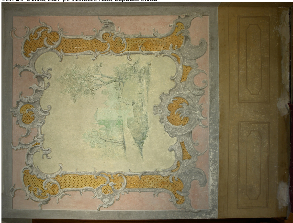
Obr. 29 Celek, stav před restaurováním, západní stěna
