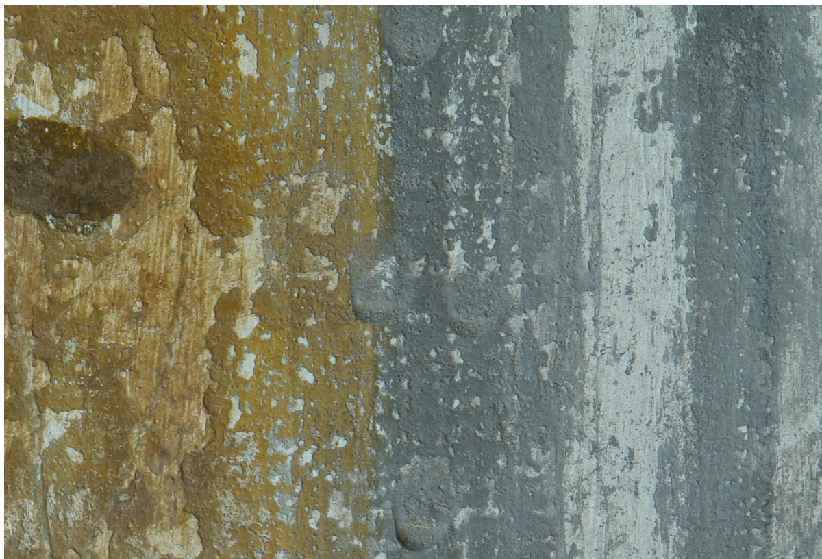
Obr. 12 Stav před restaurováním, detail barevné vrstvy, patrné zaschlé kapky přemalby
