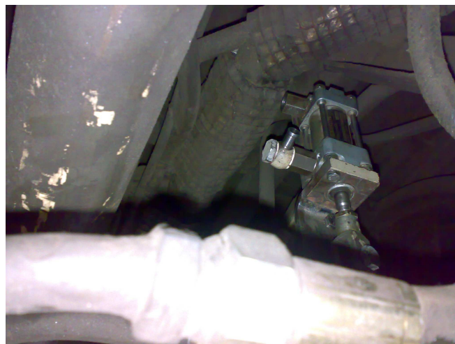
Obr. 40 - Sestava ovládání regulačního bloku na motorovém voze
